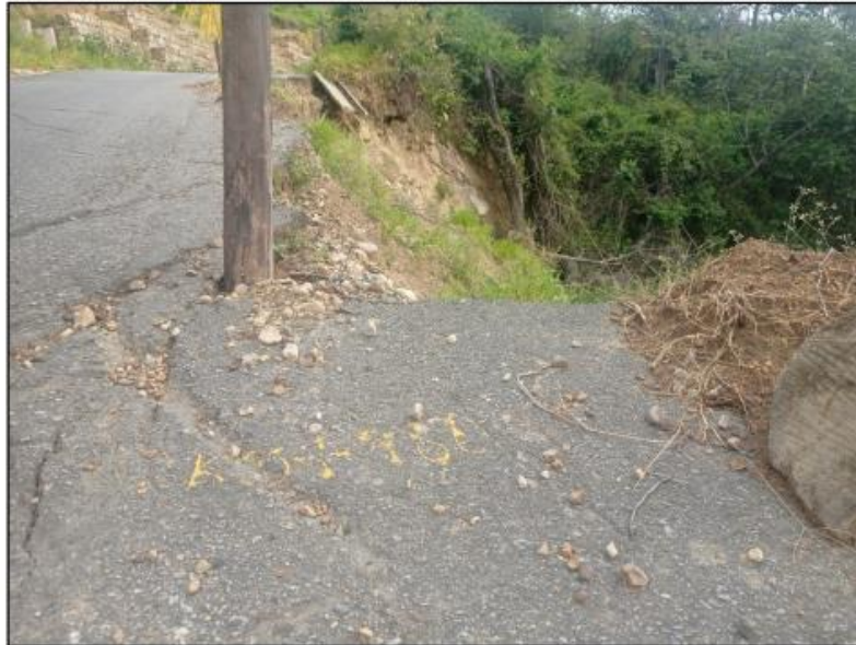
Ilustración 5. Vista panorámica del tramo de vía en condición de inestabilidad, K3+960 - K4+000.
