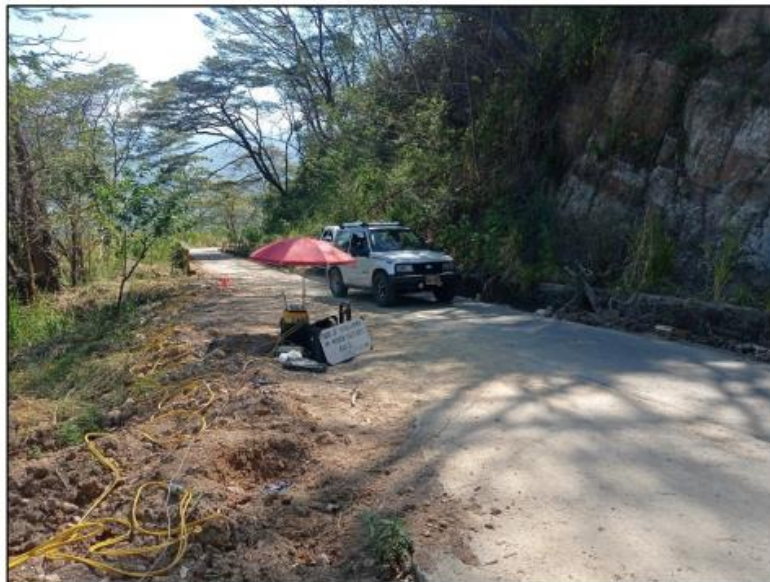
Ilustración 6. Vista panorámica del tramo de vía en condición de inestabilidad, K3+760 – K3+780.
