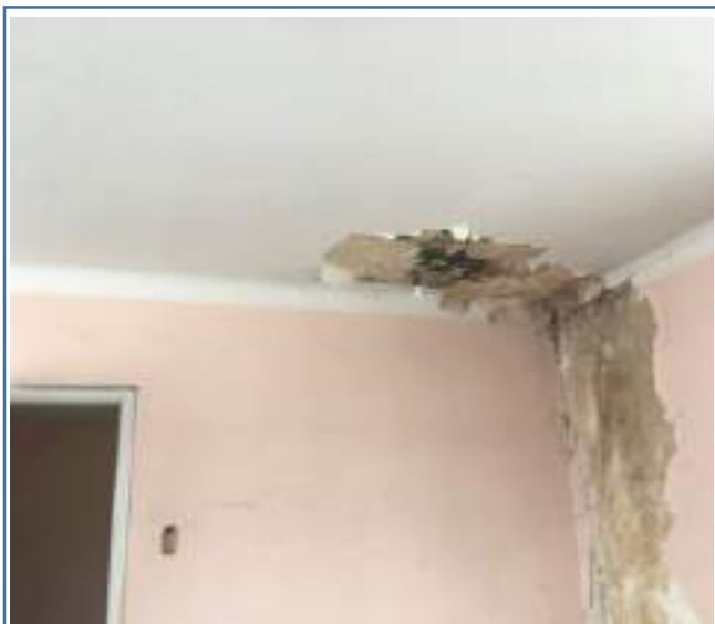
Foto 49. Muro esquina techo alcoba 2 - inicial
