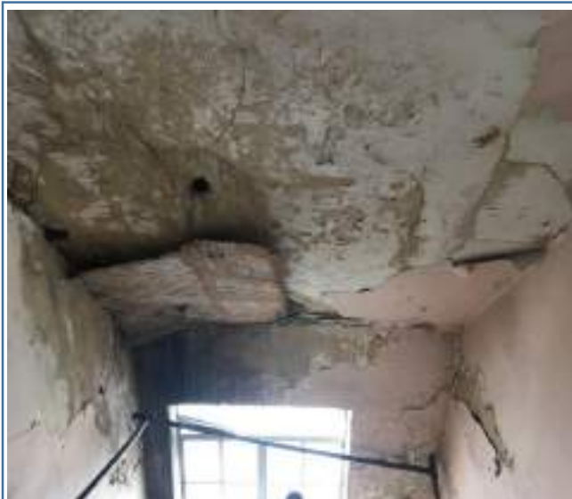
Foto 29. Techo sobre escalera entrada altillo - inicial
