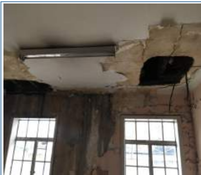
Foto 95. Muros y cielo raso alcoba 4 - inicial
