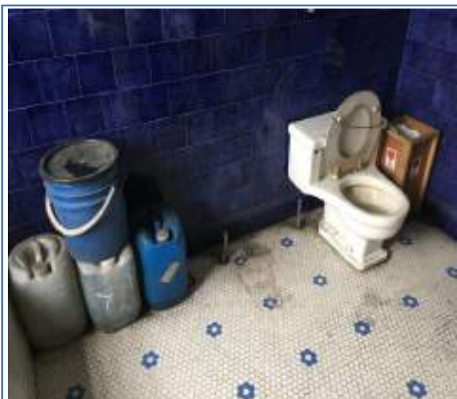
Foto 147. Sanitario Baño principal - inicial
