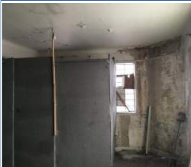
Foto 57. Muros y techo alcoba 1 - inicial
