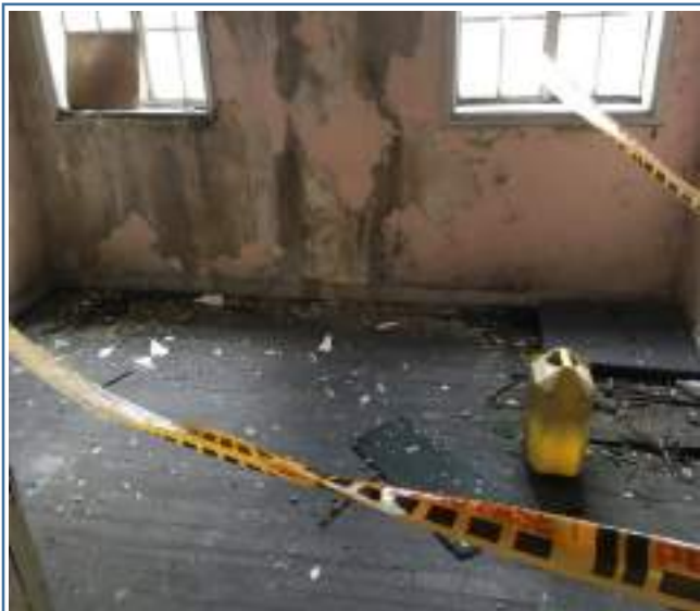
Foto 93. Muros y piso alcoba 4 - inicial
