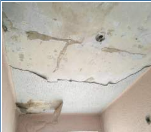
Foto 129. Cielo raso baño auxiliar - inicial
