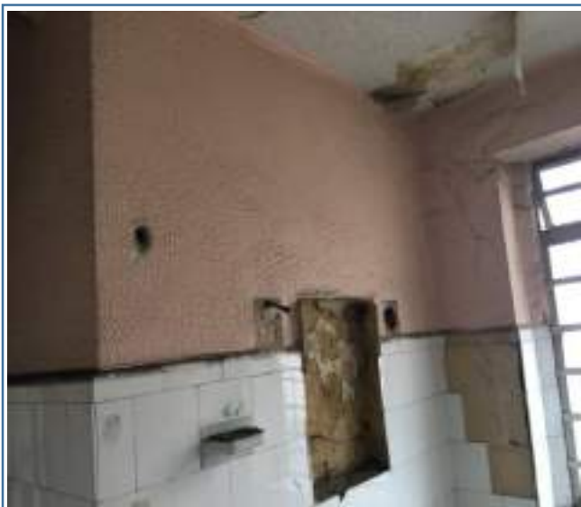
Foto 133. Esquina muro techo baño auxiliar - inicial
