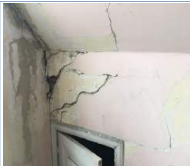
Foto 1. Esquina muro altillo estado inicial
