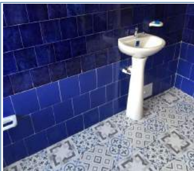
Foto 148. lavamanos Baño principal - final
