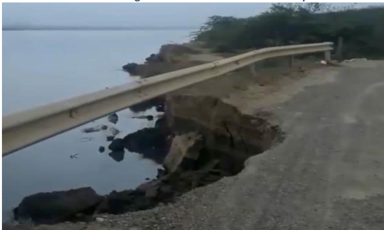
Ilustración 1. Imagen de la erosión ocasionada por el río
