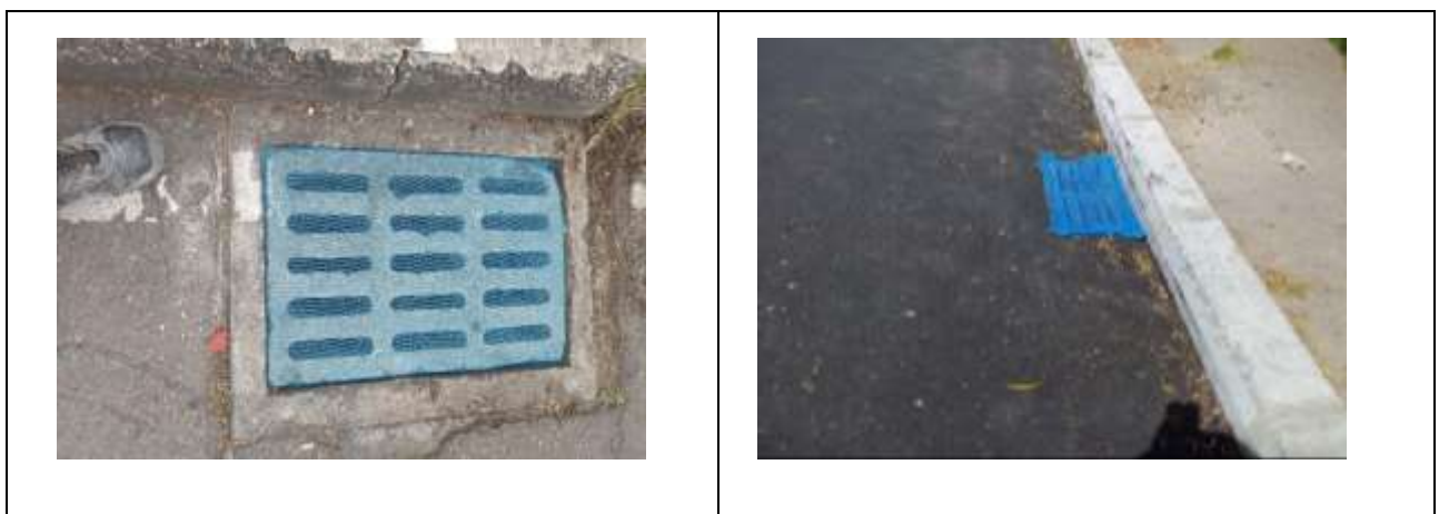
Ilustración 8. Protección de sumideros
