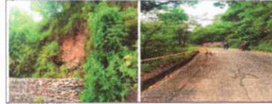
Figura 5. Identificación ambiental área afectada
