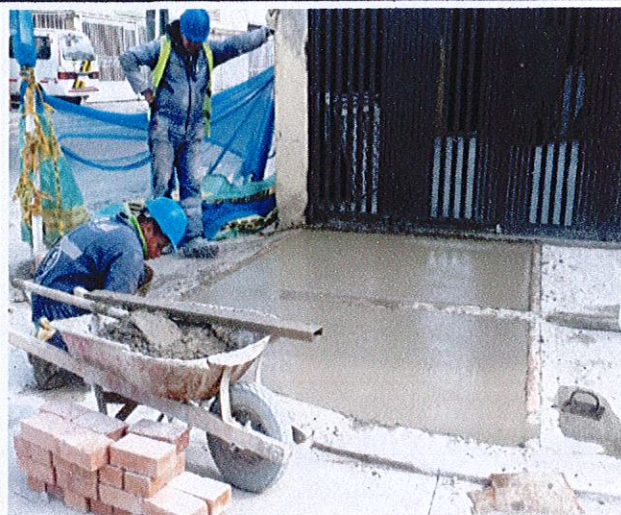
CIV 16002769 - Fundida de espacio público faltante.
