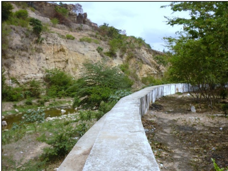
Foto 9 Erosión en surcos y carcavamiento sobre los taludes localizados sobre la margen izquierda del río de Oro, frente al barrio Santa Cruz de Girón
