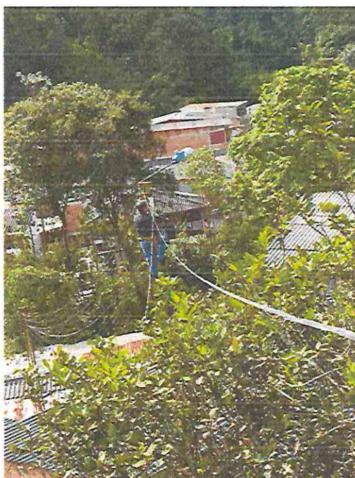
Conexión de acometida eléctrica a poste principal
