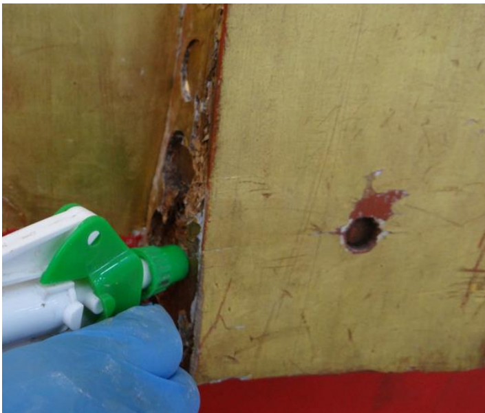
Fotografía 18 Humectación en el área deformada
