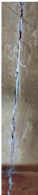
Fotografía 39 Tela enyesada en zona de grieta
