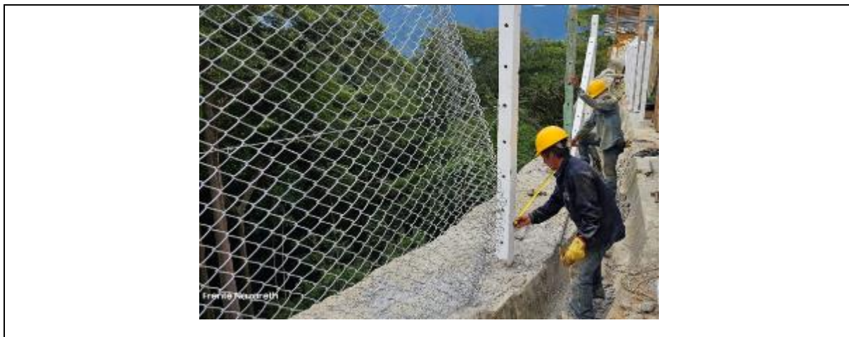
Fotografía 38. Cerramiento en malla eslabonada y poste de concreto a 2m– Sector Nazareth
