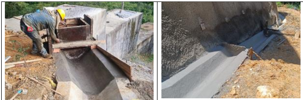
Fotografía 39 - Canaleta – Sector Nazareth
