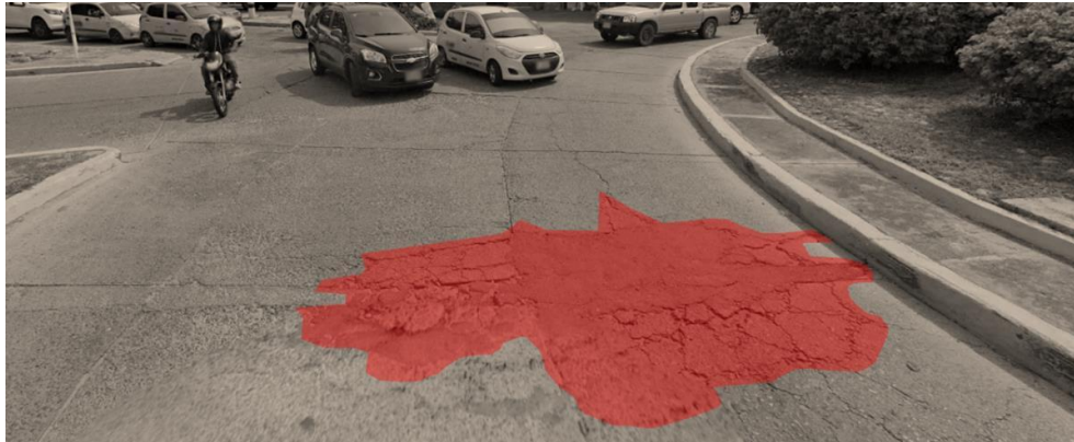
Ilustración 11. Estado estructura de pavimento María Mulata
