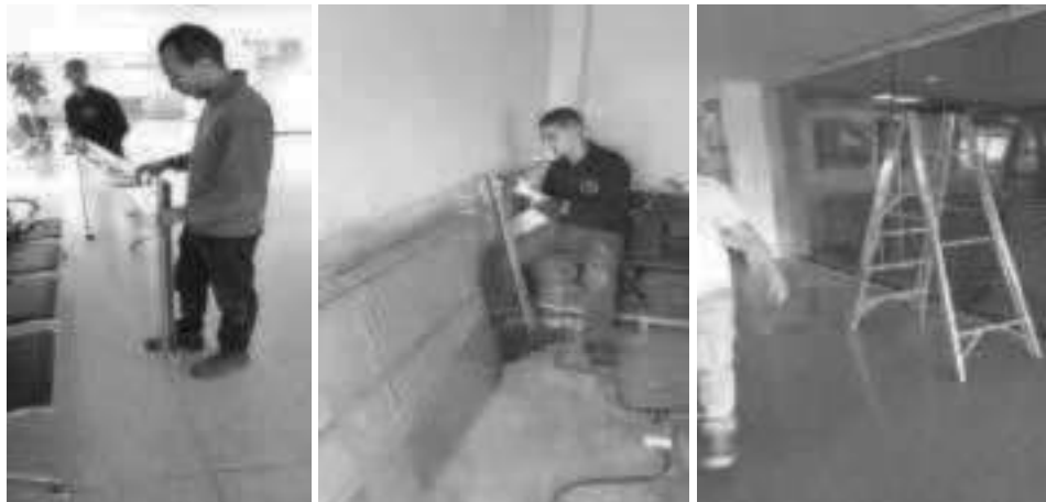
(Puerta vidrio) – Pega puerta al piso – Piso N° 5 – Occidental – Acceso Comunicaciones y Cooperación
