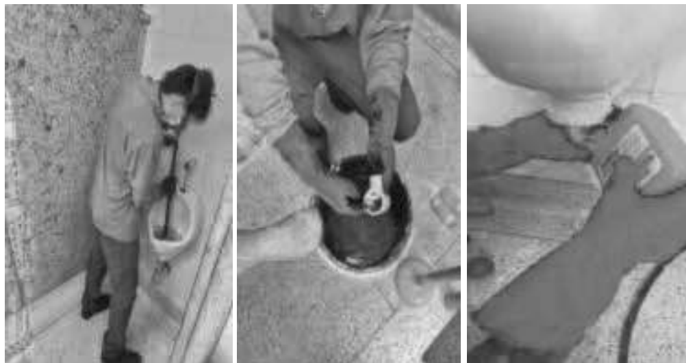
Cambio desagüe de orinal (tapado) aplicar Kankro – Lado oriental - Piso N° 2 – Baño caballeros
