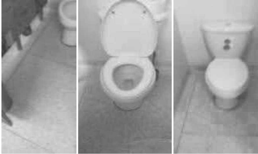
Cambio biscocho (sanitario) – Lado oriental - Piso 4 – Baño damas
