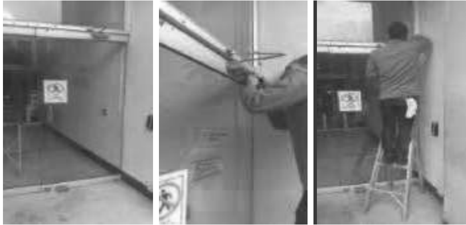
Pega contra el piso la puerta de vidrio – piso N° 1 - puerta restringida occidente
