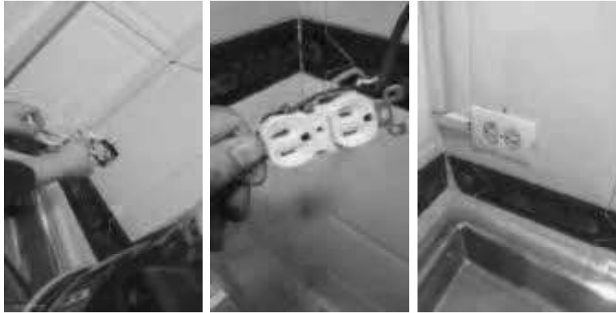
Cambiar toma eléctrica normal (quemada) – Piso N° 2 – Occidente – Cocina – Punto greca
