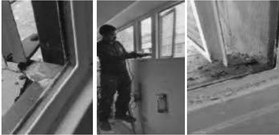
(VENTANA METALICA) – Caída dos (2) ventana pequeña de base inferior – Piso N° 4 – Lado occidental – Baño damas
