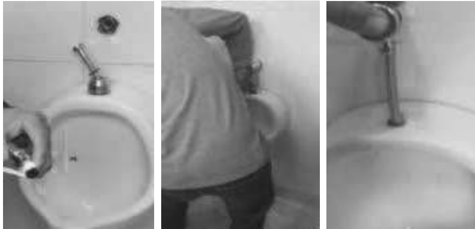
Cambio PUSH orinal – lado occidental – piso N° 2 - baño caballeros
