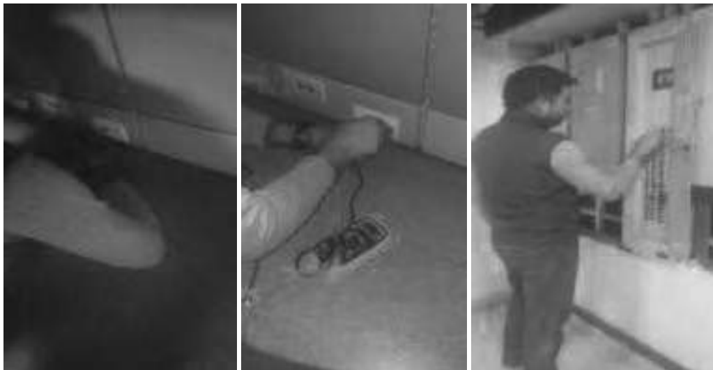
Revisar circuito normal (corto eléctrico en toma) – Se realiza cambio – 4to piso - Occidental - Fomento para la educación superior (área impresora)
