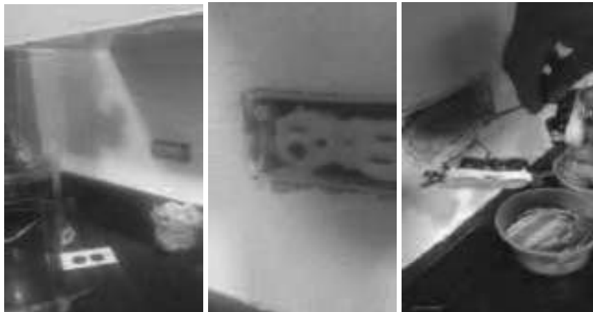
Se quemó la toma corriente normal – 5to piso - Despacho Ministra - Cocina
