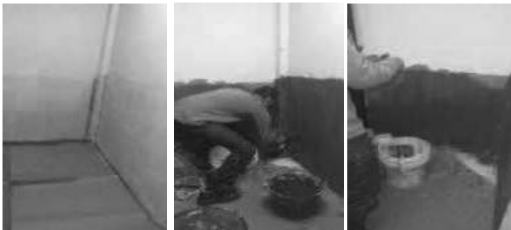
(Impermeabilizar y resanar, pintar muro (presenta filtración)) – PINTURA EDIFICIO – Muro fachada calle 43 – Sótano – Bodega N° 20.
