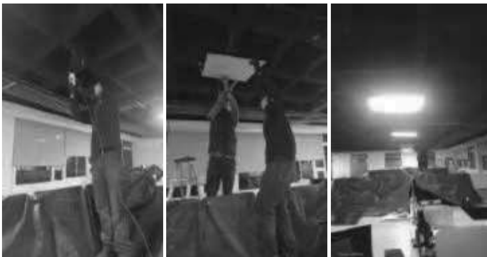
Reubicar luminarias panel led 60x60 – Piso N° 2 – Oriente – Talento Humano – Fachada parqueadero
