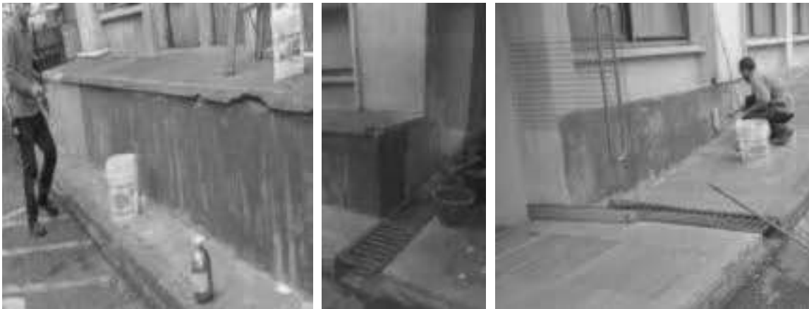
Impermeabilizar, resanar con sika y pintar muro – pintura edificio - muro deteriorado por el agua y filtra – parqueadero salida sótano Ministra - muros fachada parte baja y ventanas.
