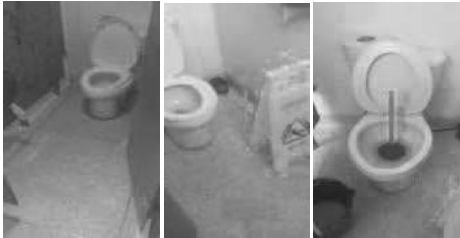
Sanitario tapado (destapar) – Lado oriental - Piso N° 4 – Baño caballeros
