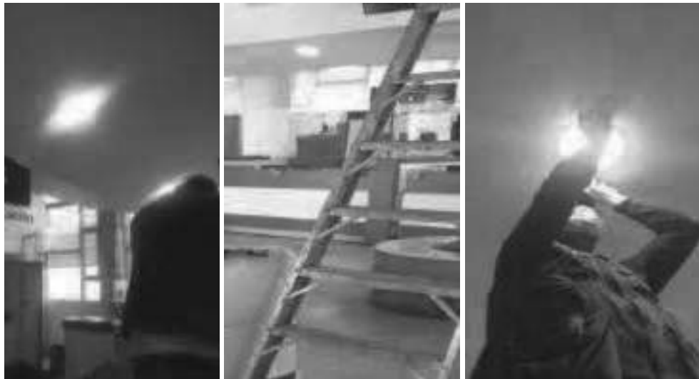
Cambiar panel led 18w redondo (quemado) - Piso N° 1 – Oriente – UAC – Taquilla 1
