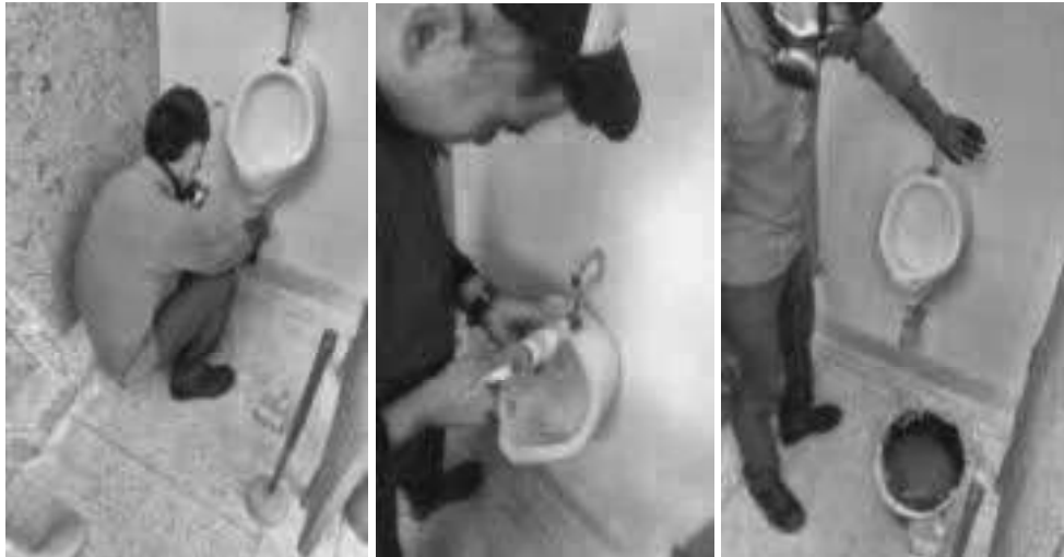
Cambio desagüe de orinal (tapado) aplicar Kankro – Lado oriental - Piso N° 3 – Baño caballeros
