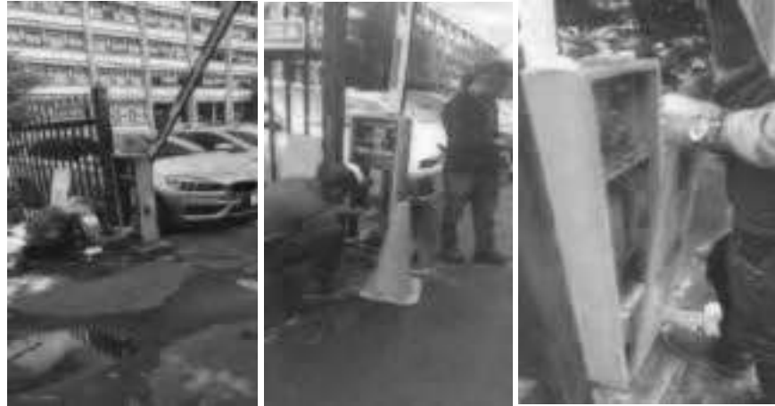
Energizar sistema para subir talanquera parqueadero – Parqueadero – Talanquera salida
