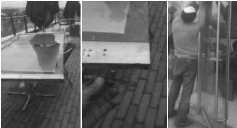
Puerta vidrio – Pega puerta al piso (tornillos base superior) – Subir puerta vidrio – 5to Piso - Cafetería - Fachada carrera 57.
