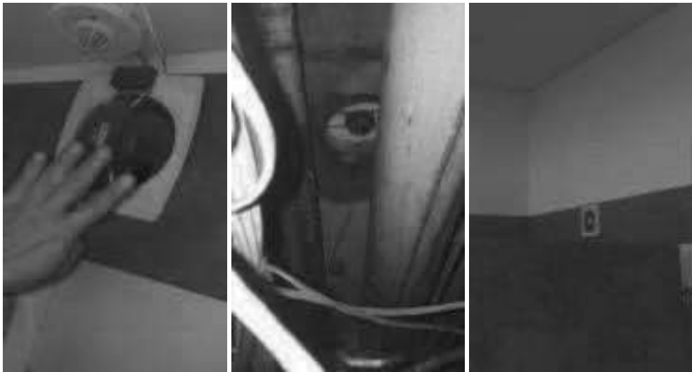
Revisar extractores baños lado oriente
