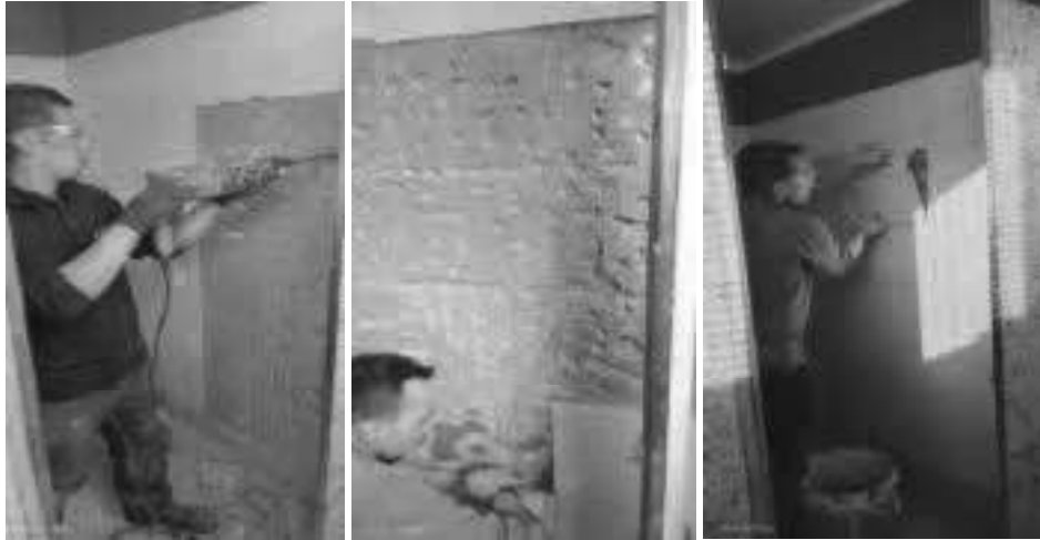
(ALBAÑILERÍA ENCHAPE) – Pintura, albañilería e impermeabilización pintura edificio – Baldosa suelta en muro baño – Piso 4 lado occidental - Baño damas.
