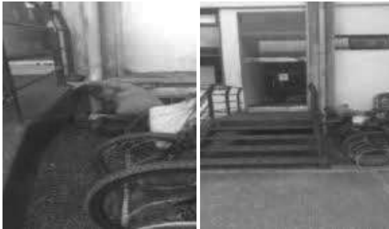
(Otros – Escalera metálica restringida) Asegurar base escalera metálica acceso a parqueadero costado occidental.
