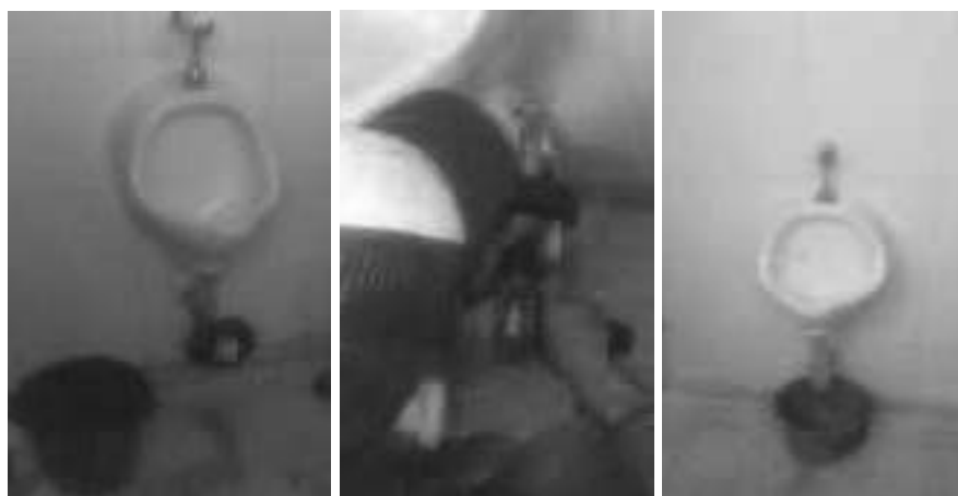
Tubería tapada orinal (destapar) – Lado oriental - Piso N° 4 – Baño caballeros
