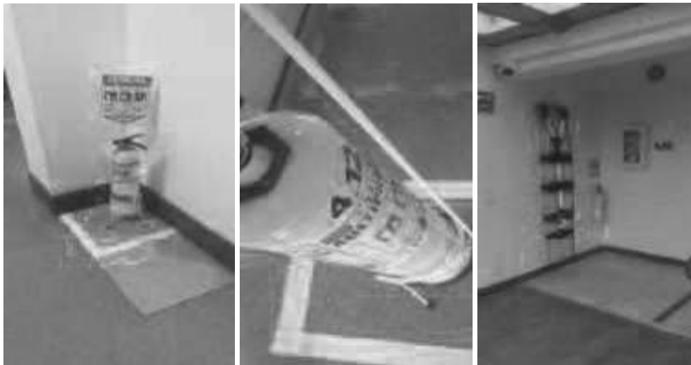
Otros – Vidrio – Otros - Respuesta a revisión extintores – MEN.
