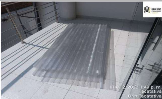
cubierta traslucida sin instalar
