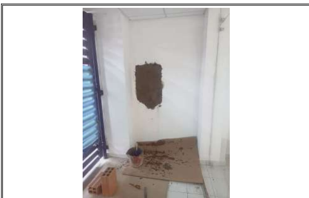
coloccion de pañete en nicho donde se encontraban contadores electricos
