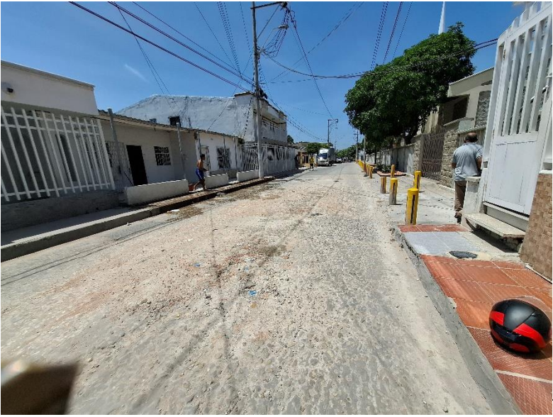
Recorrido para análisis de afectación Calle 745b con carrera 4, barrio la ciudadela
