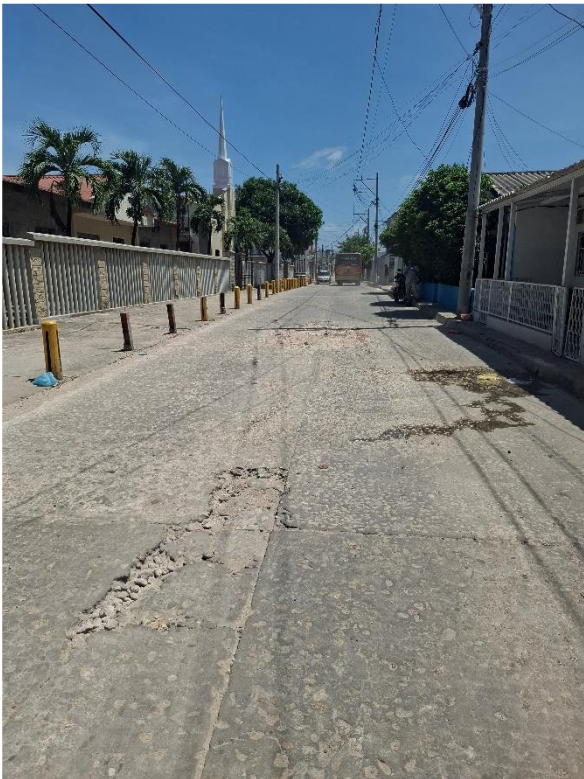
Recorrido para análisis de afectación Calle 745b con carrera 4, barrio la ciudadela
