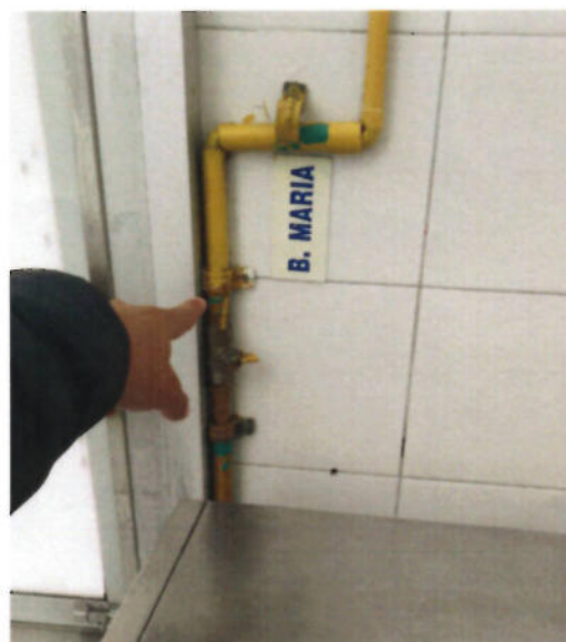
Ilustración 1: Válvulas zona baño maría
