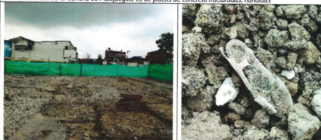
Al efectuar la demolición de la placa de concreto, se pudo evidenciar la presencia de material orgánico en la base de soporte de la placa.
