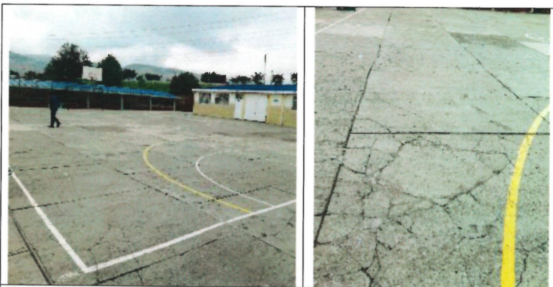
El estado inicial de la Cancha de Multijuegos, es de placas de concreto fracturadas, hundidas
