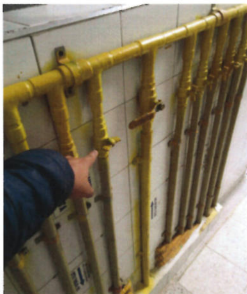
Ilustración 2: Válvulas zona marmitas
