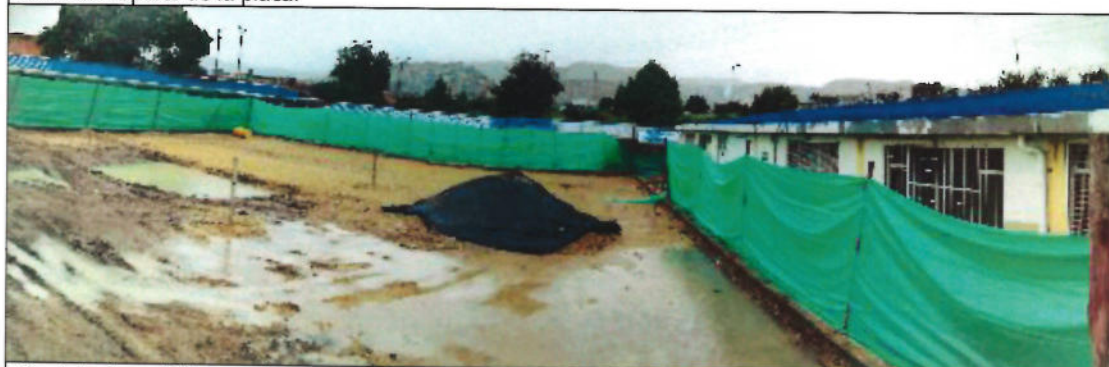
Se detectaron fallos en el terreno de soporte de la placa de concreto, por lo que se dieron mayores cantidades en excavación y lleno de los mismos.
