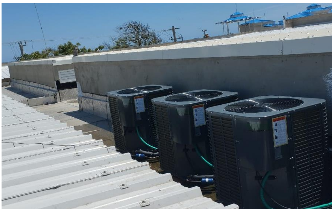
INSTALACION DE LAS (3) CONDENSADORAS
