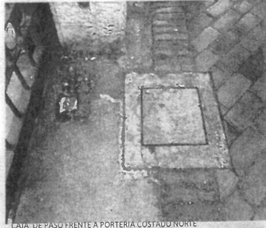
CAJA DE PASO FRENTE A PORTERIA COSTADO NORTE
