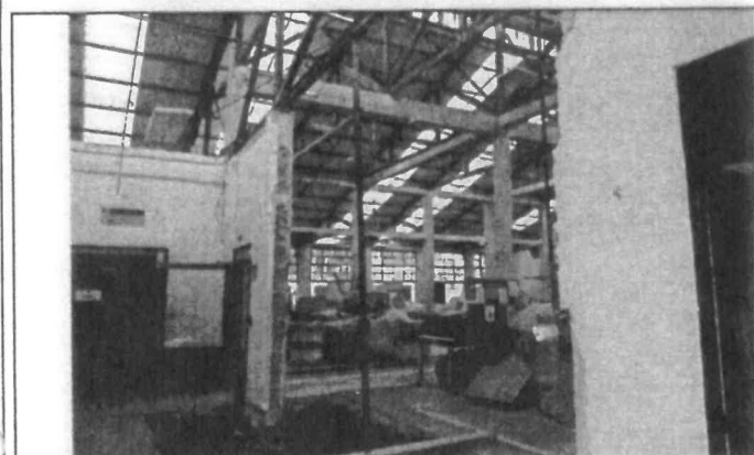
Foto No. 37: Se revisa y verifica las condiciones de seguridad de la cercha en el áreas de producción, la cual se requiere mejorar la repartición de carga con más paraleles, se le informa al contratista CONSORCIO PRUNI SEDES 04
