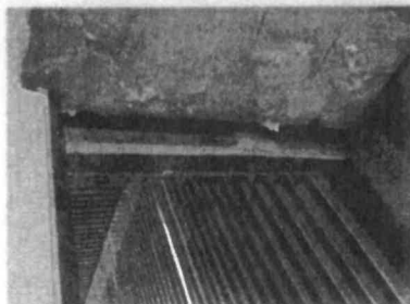
HUMEDAD EXISTENTE POR GOTERA SOBRE PUERTA
