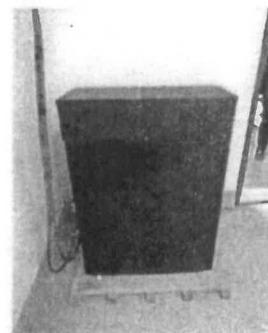
EQUIPOS EN BUEN ESTADO CUARTO TECNICO SOTANO 2
