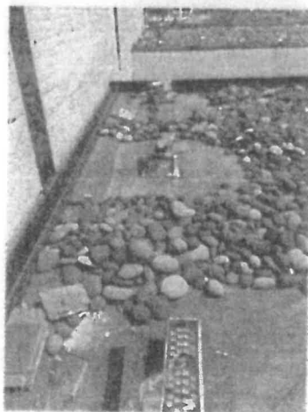
CANAL METALICA CONTRA MURO ✓
