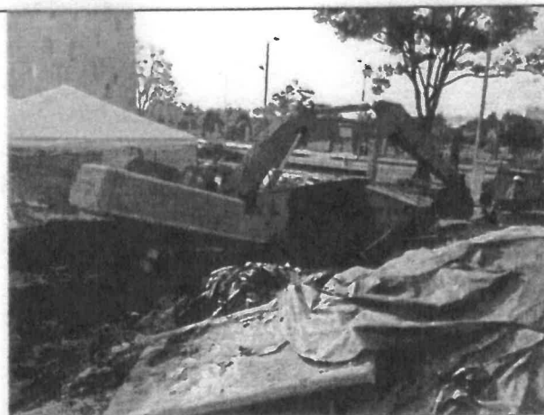
Foto No. 16: Se revisa y verifica los accesos en malas condiciones en el área de trabajo. de la excavación costado occidental y se le informa a la profesional (SST) TANIA ERIKA ROMERO LEAL para que tome los respectivos correctivos Sede CENTRO MEMORIA PAZ Y RECONCILIACIÓN
