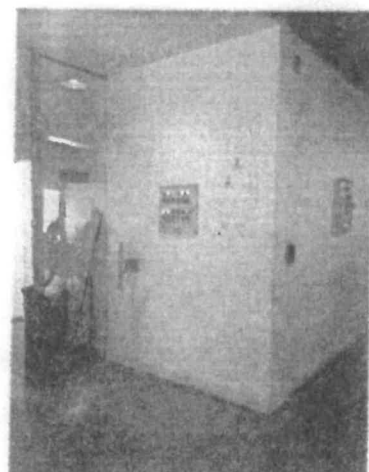
AREA TABLERO DE DISTRIBUCION PARQUEADERO ✓
