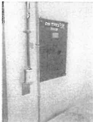
Caja de distribución eléctrica
