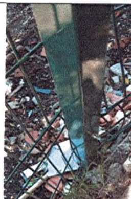
EVIDENCIA DE CERRAMIENTO VIOLENTADO
