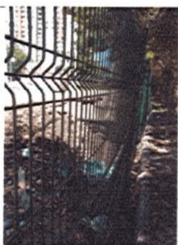
EVIDENCIA DE CERRAMIENTO VIOLENTADO
