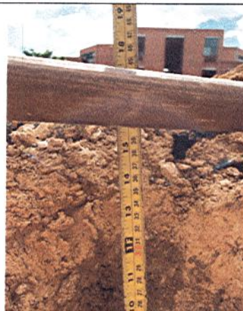
APIQUE A 0,40 CM REVISIÓN DEL SUELO
