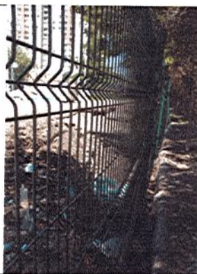
EVIDENCIA DE CERRAMIENTO VIOLENTADO
