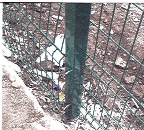
EVIDENCIA DE CERRAMIENTO VIOLENTADO
