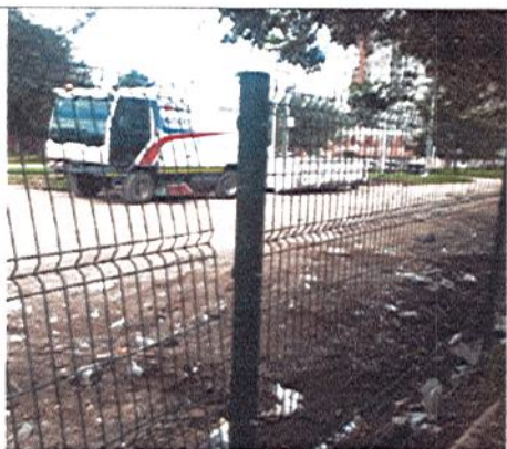
EVIDENCIA DE CERRAMIENTO VIOLENTADO
