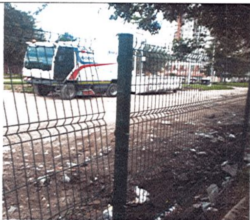
EVIDENCIA DE CERRAMIENTO VIOLENTADO
