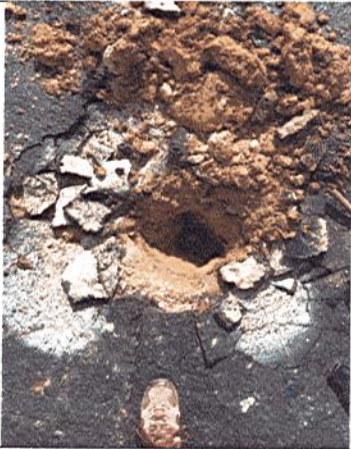
APIQUE A 0,40 CM REVISIÓN DEL SUELO
