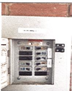
MARQUILLADO EN TABLERO ELECTRICO
