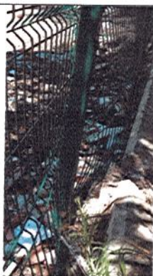
EVIDENCIA DE CERRAMIENTO VIOLENTADO
