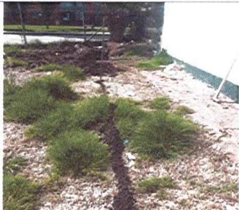
DEMARCACIÓN PARA ACOMETIDA
