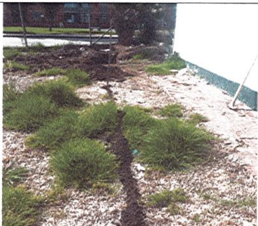
DEMARCACIÓN PARA ACOMETIDA
