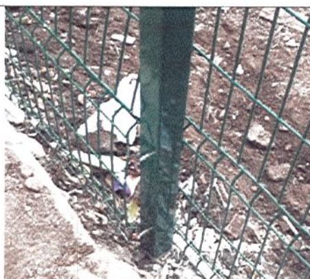
EVIDENCIA DE CERRAMIENTO VIOLENTADO
