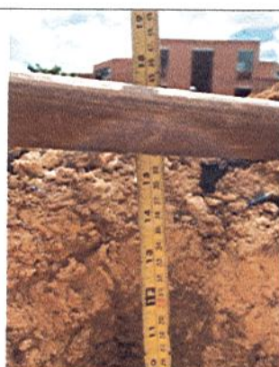
APIQUE A 0.40 CM REVISIÓN DEL SUELO
