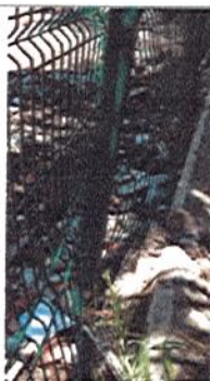
EVIDENCIA DE CERRAMIENTO VIOLENTADO
