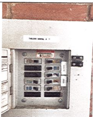
MARQUILLADO EN TABLERO ELECTRICO
