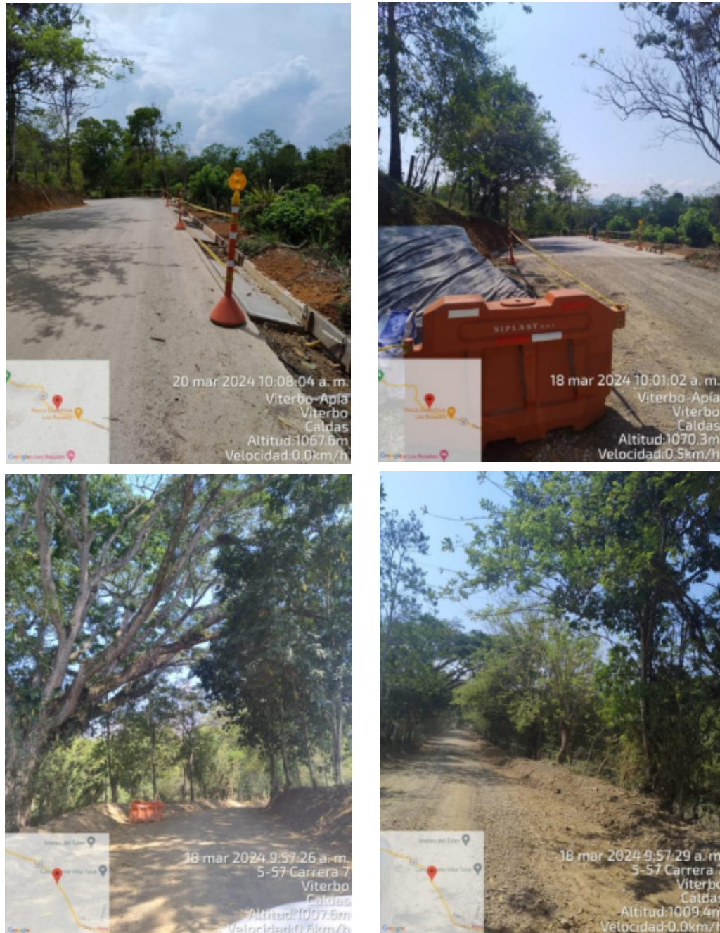
FOTOGRAFÍA 1 Recorrido evidenciando ausencia de personal en obra
