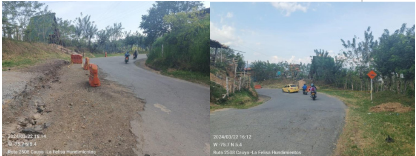
Fotografía 4 Señalización inestable y deficiente
