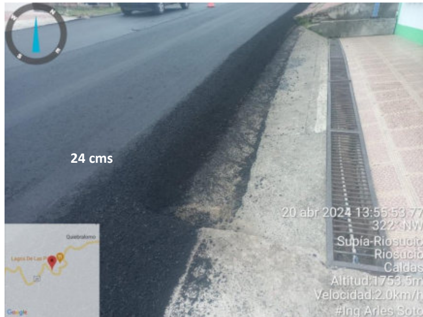
Fotografía 3: Ingreso al predio de la señora Suarez PR 40+200 RUTA 2508
