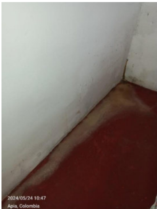
Fotografía 5: ingreso de agua en predio de Jairo Puerta PR 58+800 RUTA 5003
