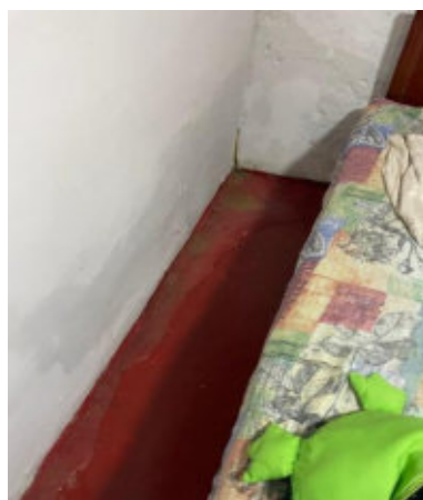
RF 5. Afectación vivienda Apia Rda.
