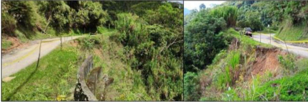
Fotografía 1. Estado actual del sitio de estudio, deslizamiento.
