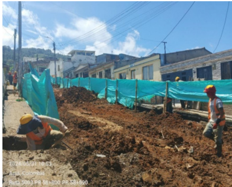
Fotografía 2: Estado de la calle 11 entre carrera 5 y 8, al 31/05/2024
