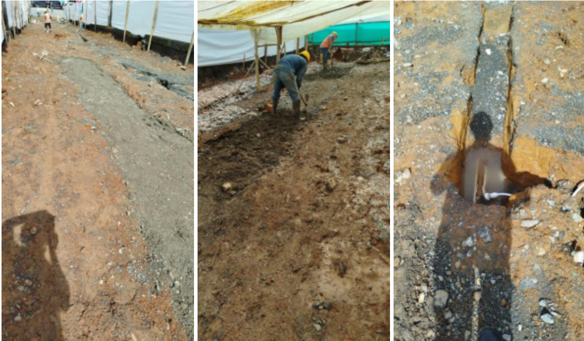
Fotografía 2 estado subrasante visita 18 junio 2024
