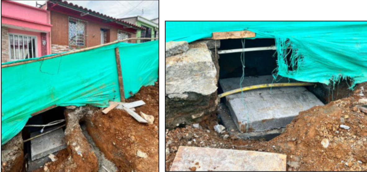
Figura 20. Cajas de inspección de acometidas de Alcantarillado – Cant: 13 Cajas
