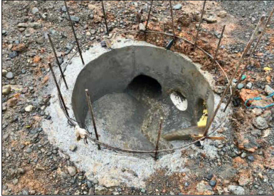
Figura 14. Cámara de inspección CM-53 localizada en la carrera 5.
