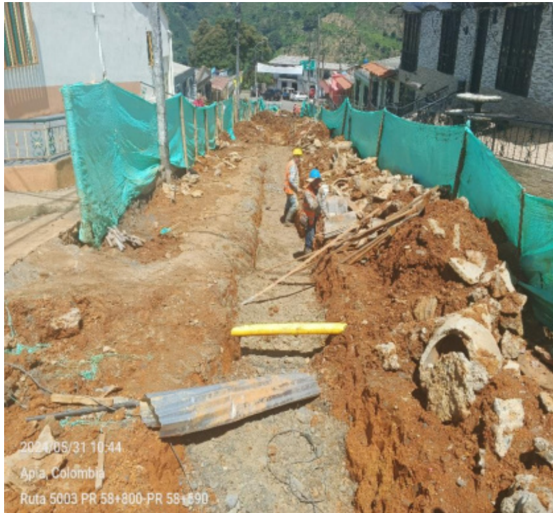
Fotografía 3: Estado de la calle 11 entre carrera 5 y 8, al 31/05/2024
