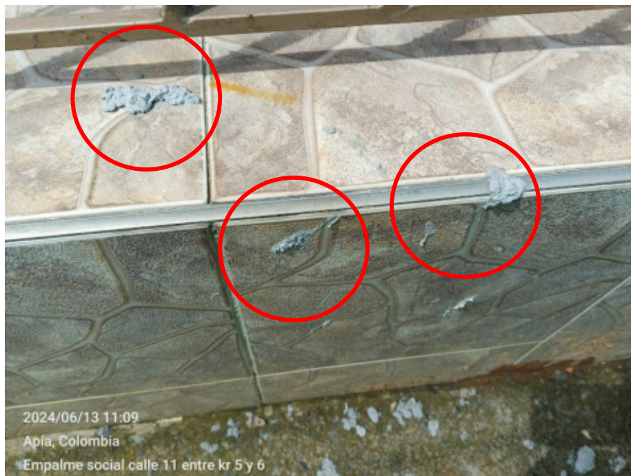
Fotografía 5: Afectaciones en fachadas por concreto
