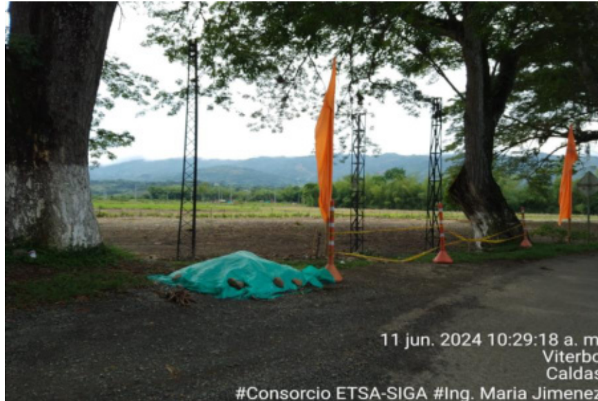
Fotografía 3: abandono de actividades PR 77+300
