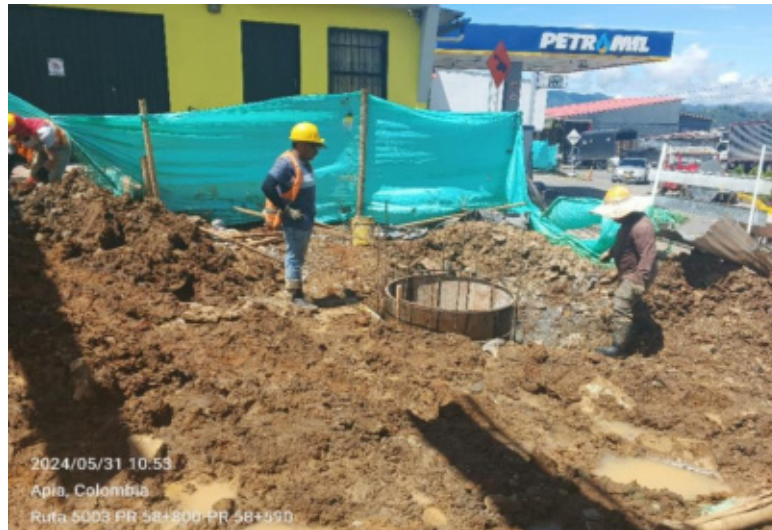
Fotografía 1: Estado de la calle 11 entre carrera 5 y 8, al 31/05/2024
