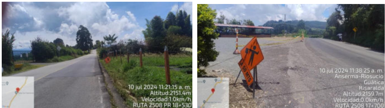
Ilustración 3 PR 17+300 Señalización retirado de la zona de actividades y ubicada en el carril contrario
