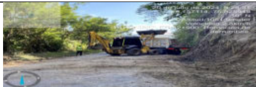
RUTA 2507 REMOLINOS - CAUYÁ - REMOCIÓN DE DERRUMBES PR42+900
