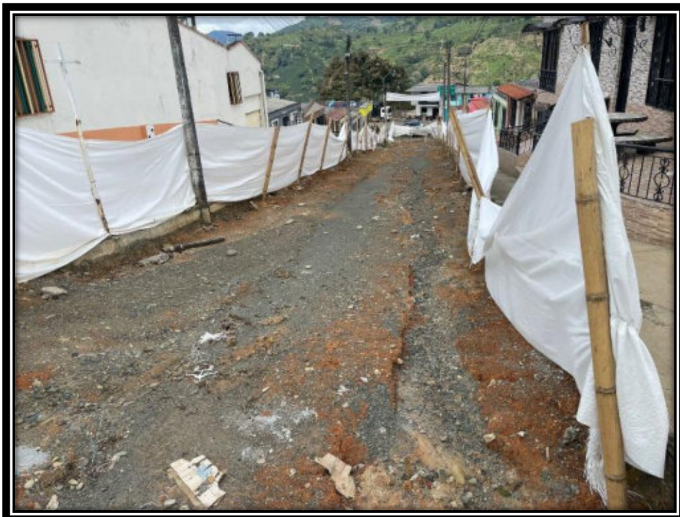
Imagen 1: Como se puede evidenciar la tramo N° 01 calle 11 entre carreras 5 y 6 tiene caído el cerramiento, y la lluvia empieza a socavar las brechas de acueducto y alcantarillado que se compactaron y entregaron.
