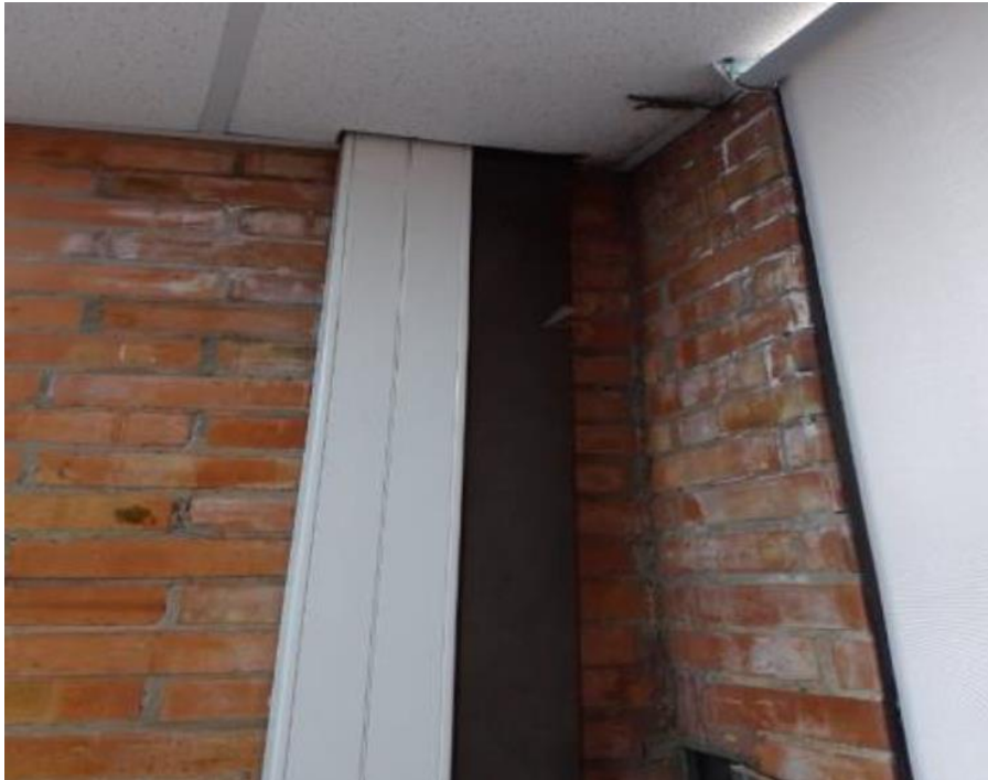
Foto: Se registran malas condiciones en la pared debido a la humedad; Sede-ORIP Gachetá. Fuente: Archivo CONSORCIO INTERAGRUPACIONES Dic-2023.
