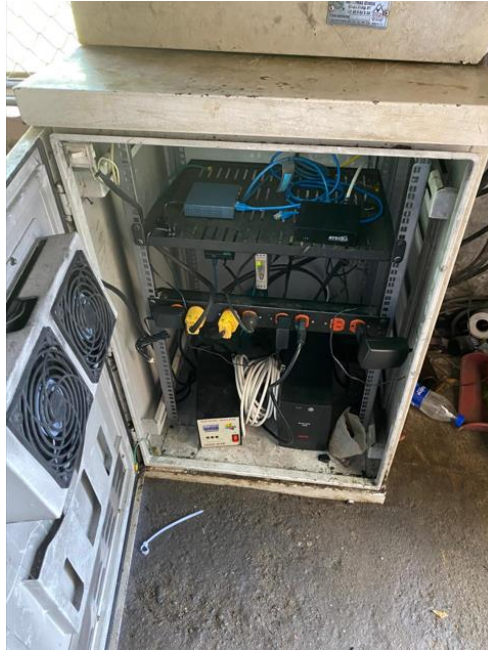
Imagen No 4 Equipos en rack
