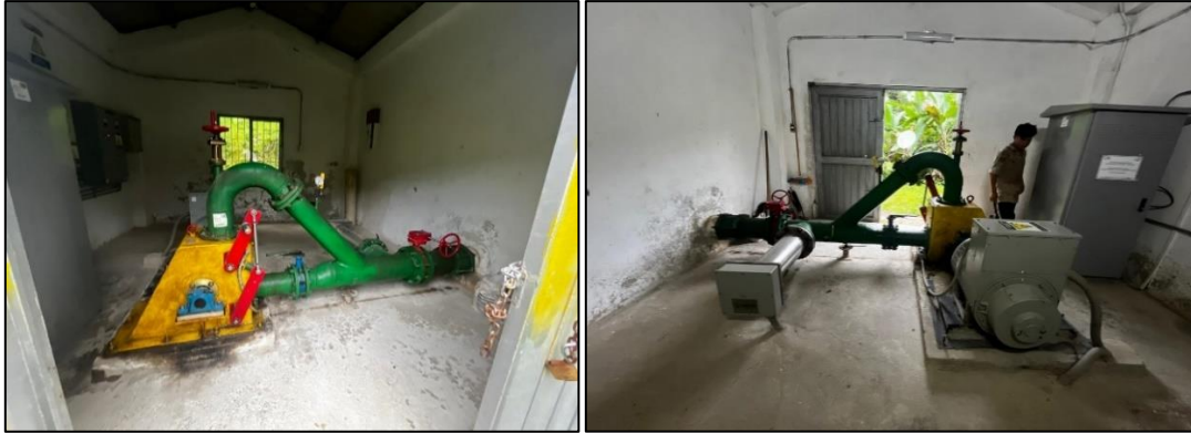
Registro fotográfico 3. Cuarto de máquinas PCH
