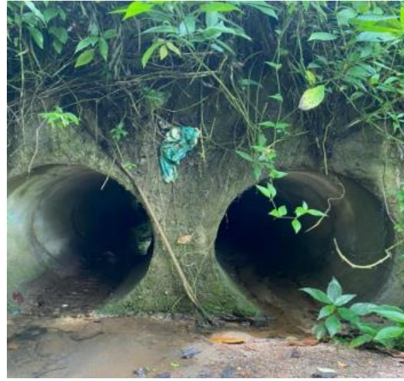
Ilustración 3 - Tubería doble de 24" con presencia de colmatación y material vegetal; Fuente, Elaboración propia
