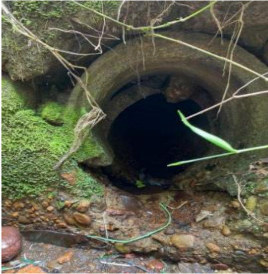
Ilustración 2 - Tubería de 24" en mal estado, Fuente propia.
