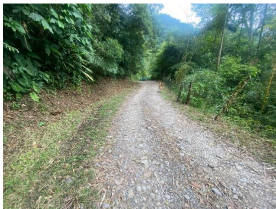
Foto No 3 Estado de la vía actual
