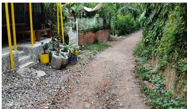
Foto No 1 Estado de la vía actual
