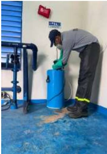
Dosificación de Químicos
