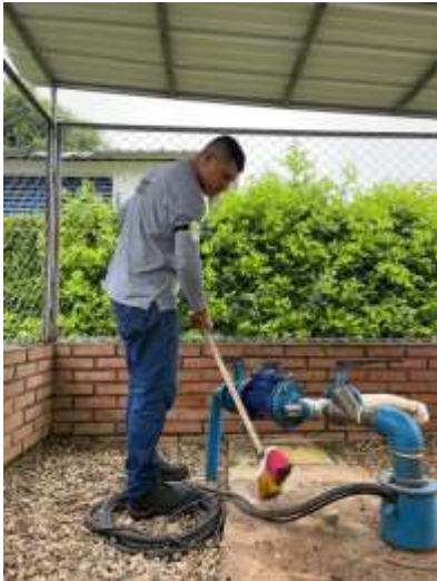
Aseo y Operación Pozo Profundo
