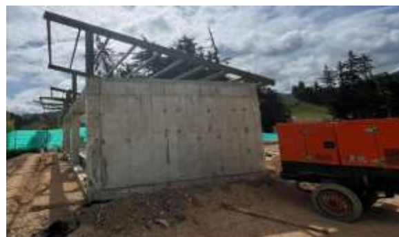
MURO ESCALADA Y PLANTA ELÉCTRICA
