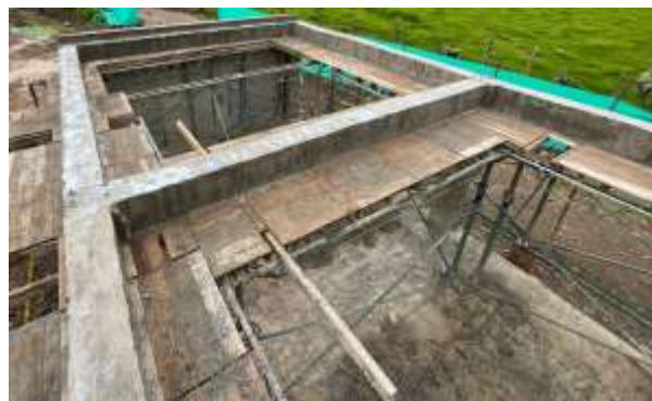
VIGAS AÉREAS Y PLATINAS ED. COMPLEMENTARIO
