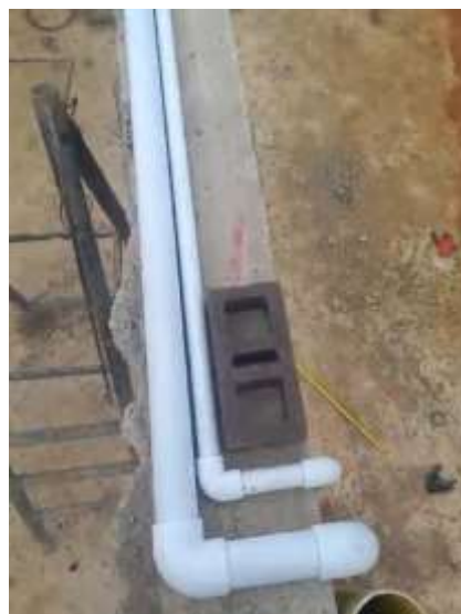
CODOS 2" CONEXIÓN TANQUE
