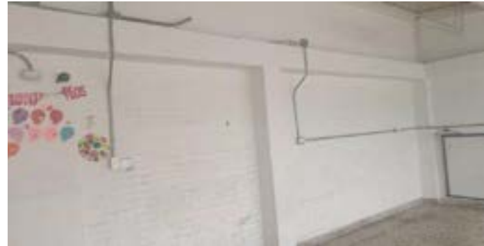
FOTO 2: ESTADO MUROS Y TUBERIA ELECTRICA
