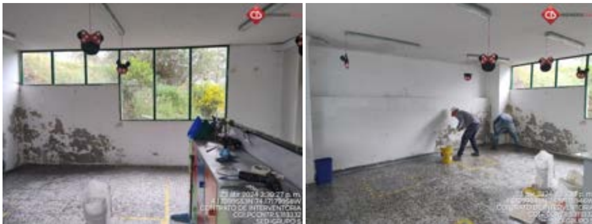
Ilustración 4. Humedad presente en salón preescolar.
