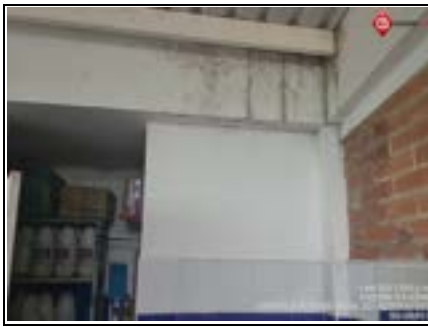
ESTADO INICIAL: GIMNASIO DEL CAMPO JUAN DE LA CRUZ VARELA SEDE SAN JUAN
