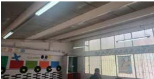
FOTO 1: VENTANA E ILUMINACION
