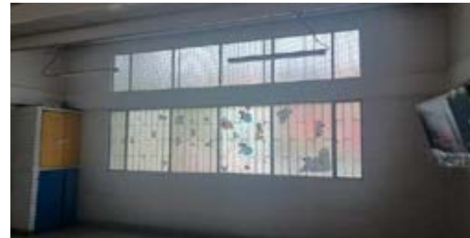
FOTO 2: VENTANA Y APARATOS ELECTRICOS
