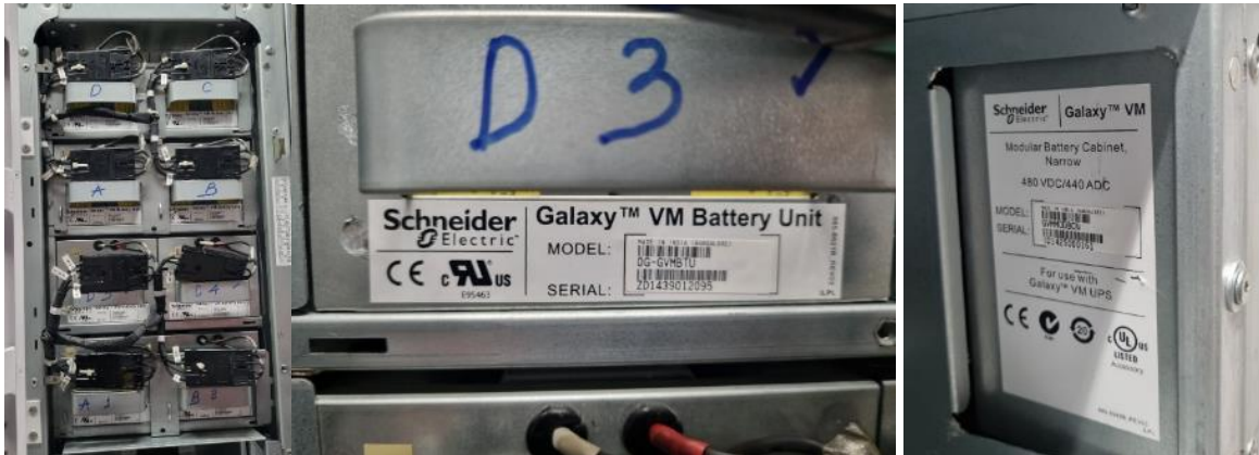
Figura 12. Banco de Baterías.
