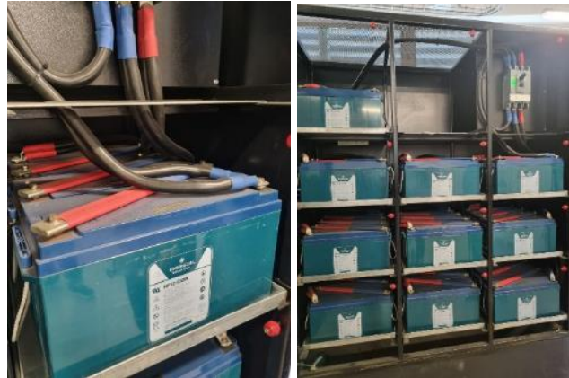
Figura 4. Banco de Baterías y conectores existentes.
