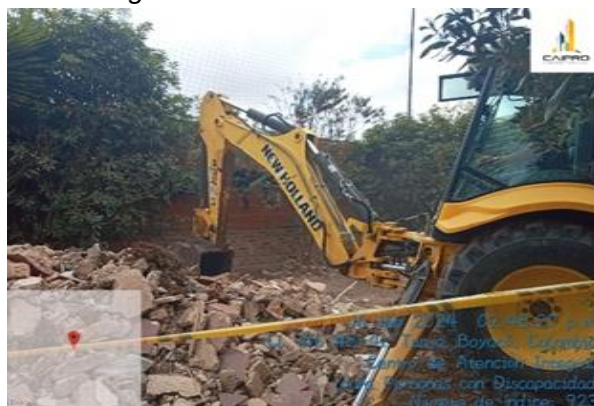
Figura 4. Señalización de RCD
