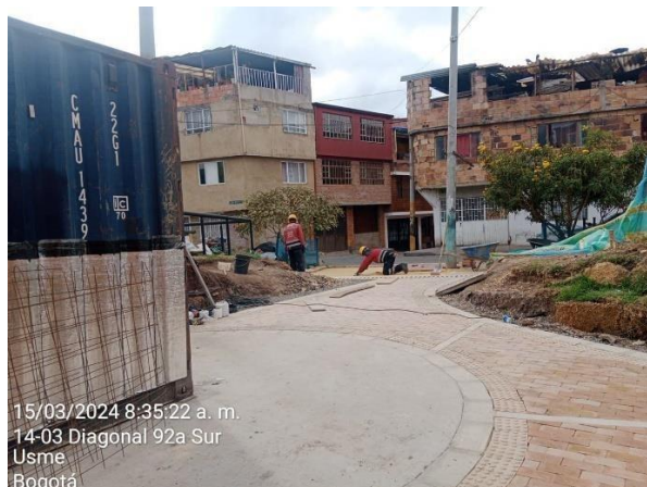
Remates canal aguas lluvias
