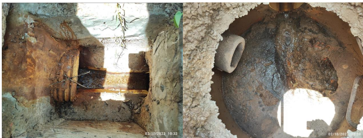
Figura 4. Estado de algunas de las redes de alcantarillado del corregimiento de Palermo Fuente: Levantamiento topográfico consultoría, 2024.
