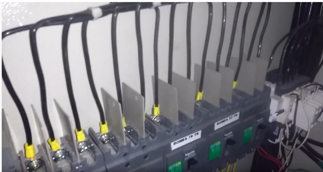
CONEXIÓN A BREAKER DE CONTROL, CABLES ADUJADOS A 90°, AMARRES PLASTICOS, MARCADO Y BREAKER ACUARDO NORMA, LÁMINAS INTERMEDIAS DE AISLAMIENTO.
