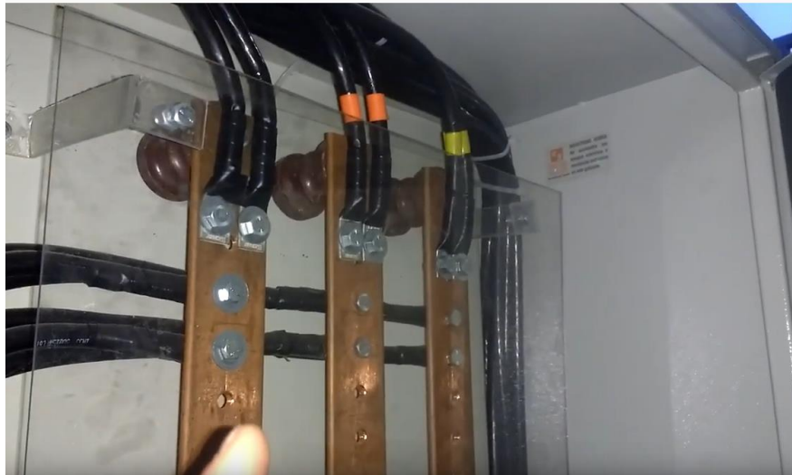
CONEXIÓN ALIMENTACIÓN, ACRILICO DE PROTECCIÓN, AISLADORES ACRILICOS, ADUJADO Y ALINEADO DE LINEAS
