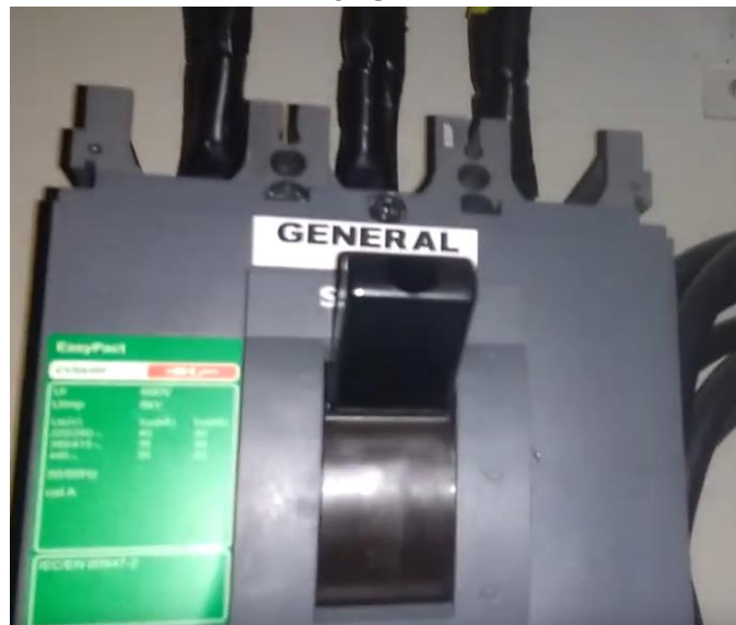
MARCADO DE BREAKER PRINCIPAL.
