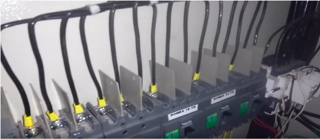
CONEXIÓN A BREAKER DE CONTROL, CABLES ADUJADOS A 90º, AMARRES PLASTICOS, MARCADO Y BREAKER ACUARDO NORMA, LÁMINAS INTERMEDIAS DE AISLAMIENTO.
