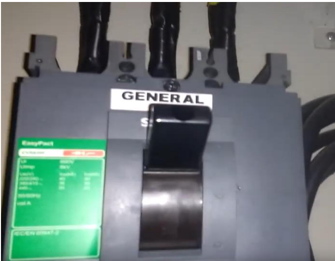
MARCADO DE BREAKER PRINCIPAL.
