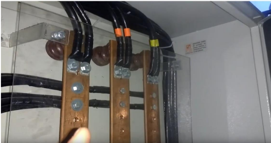
CONEXIÓN ALIMENTACIÓN, ACRILICO DE PROTECCIÓN, AISLADORES ACRILICOS, ADUJADO Y ALINEADO DE LINEAS
