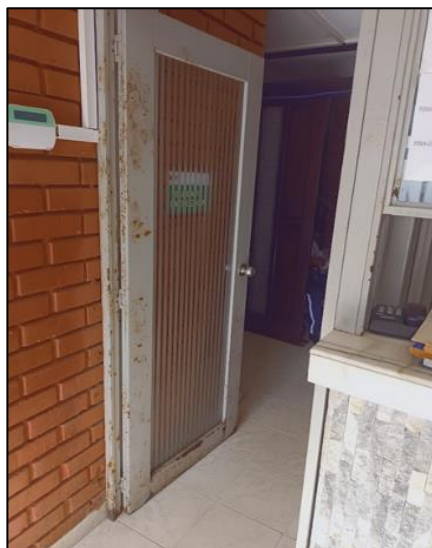
Ornamentación Existente, Oxido En Marcos De Puertas
