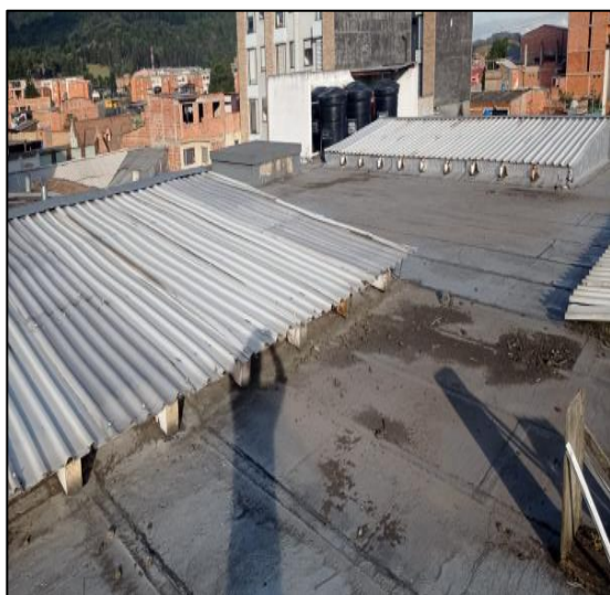
Manto Asfáltico Sin Mantenimiento
