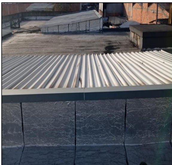
Cubierta Plástica Deteriorada Por La Intemperie
