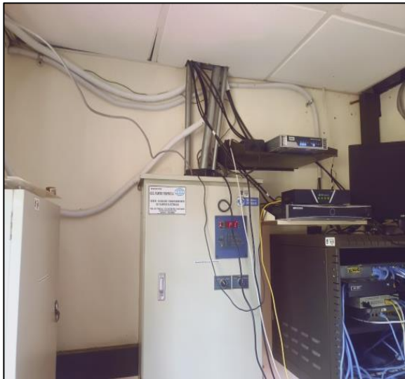
Cielo Raso Desnivelado Y Disposición De Cableado Para Rack
