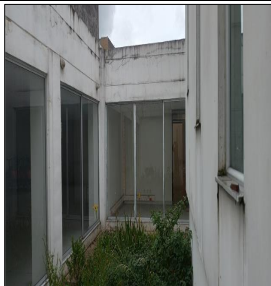
Fachada Existente, Fisura Debido A Dilatación Existente
