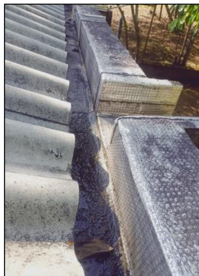
Canales Con Poca Pendiente, Gárgolas Arriba De La Base De La Canal, Impermeabilización Con Manto
