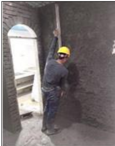
Pañete En Muros De Cafetería
