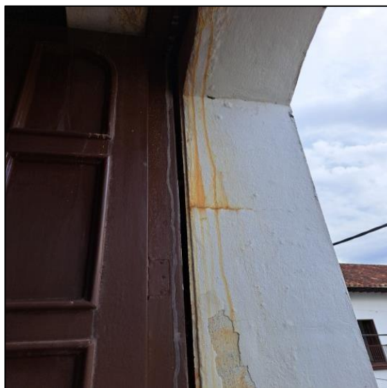
Humedades En Oficina Principal
