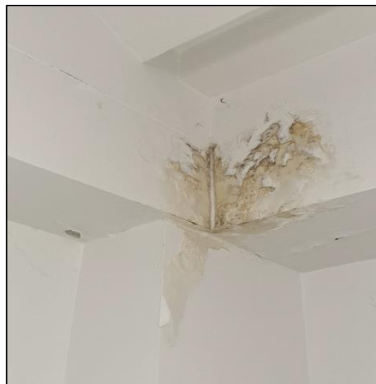
Humedad Sobre Viga Canal
