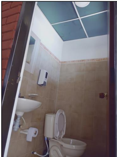
Baño Principal, Enchape Actual, Cielo Raso En Lámina Acrílica
