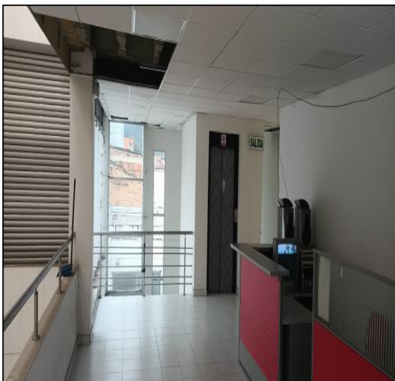
Falta De Cielo Raso En Área De Servicios De Segundo Piso
