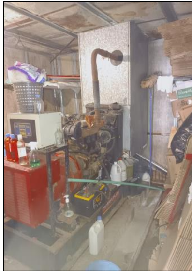
Cuarto Planta Eléctrica
