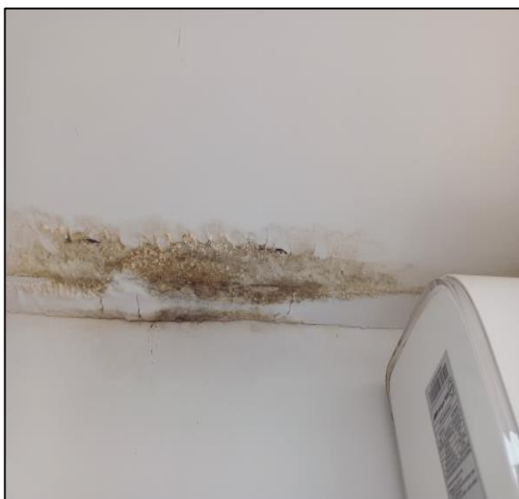
Cielo Raso Con Humedad, Debido A Filtración En Cubierta
