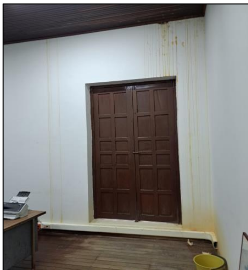
Humedades En Oficina Principal
