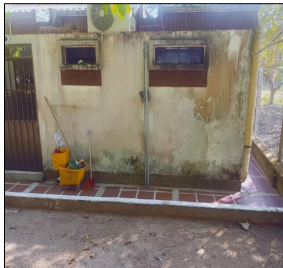
Deterioro De Fachada Posterior
