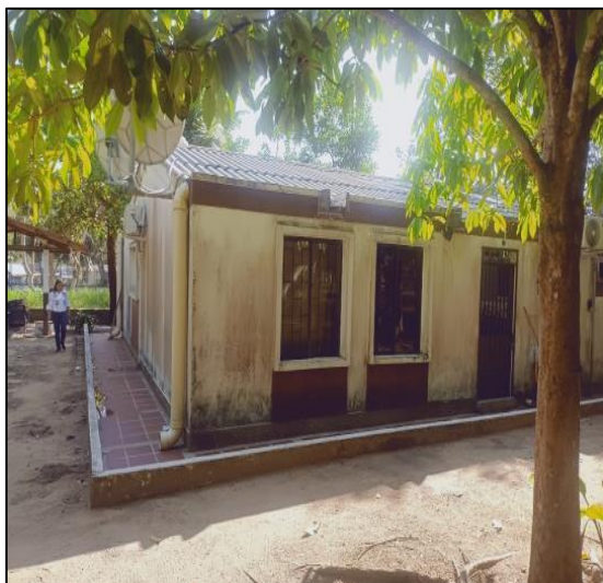
Fachadas Laterales, Desgaste De Pintura Por Inclemencia Del Tiempo, Cubierta En Asbesto Cemento
