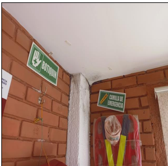
Desprendimiento De Cielo Raso En Lamina De Drywall Por Causa De Humedad
