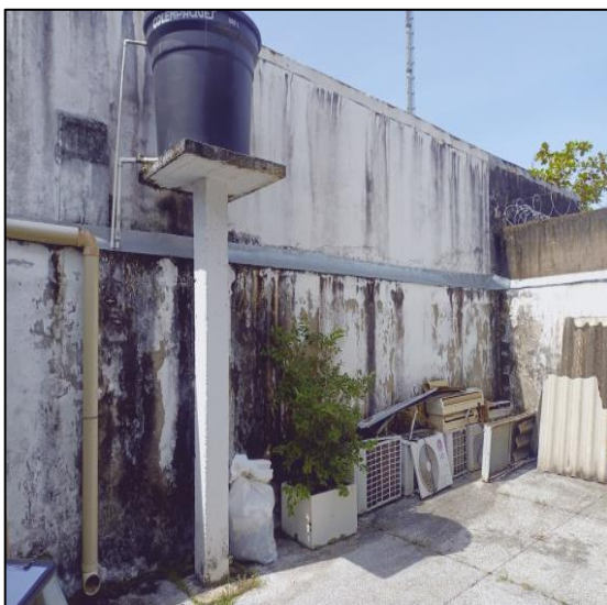
Muro A La Intemperie, Ménsula Para Tanque Elevado
