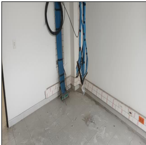
Cuarto De Rack 2do Piso
