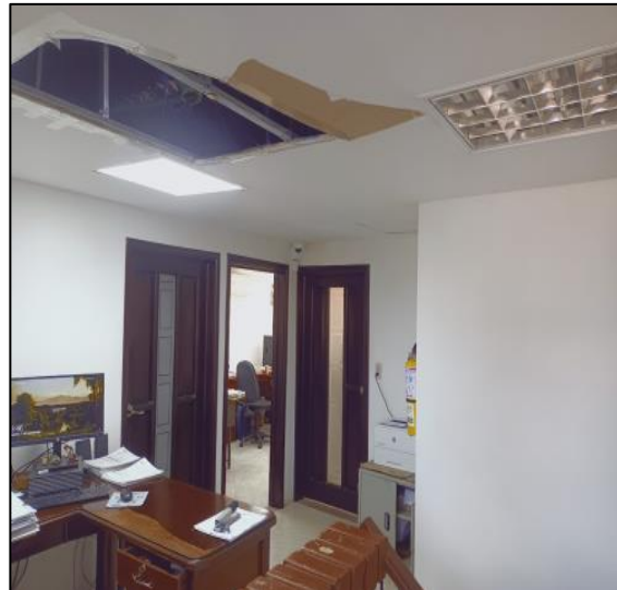
Oficina De Contabilidad, Cielo Raso En Drywall Roto, Muros En Pañete Es Tuco Y Pintura A La Vista
