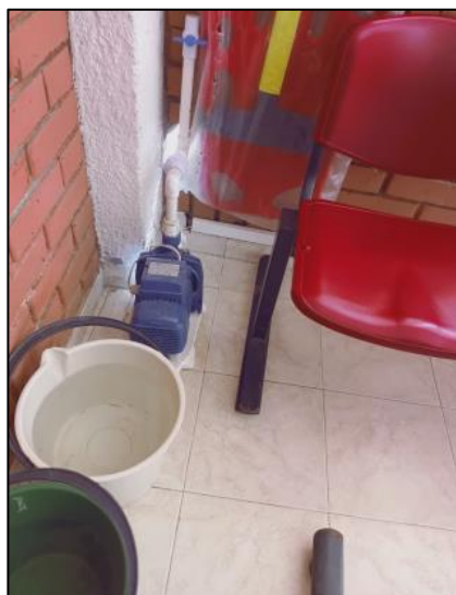
Motobomba Para Inyección De Agua A Tanques En Área De Atención Al Publico
