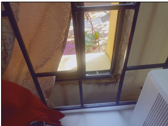
Filtraciones De Agua Y Humedad En El Marco Del Vano, Falta De Sellado En Marco De Ventana
