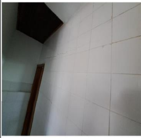
Fisuras En Enchape De Muros En Baño
