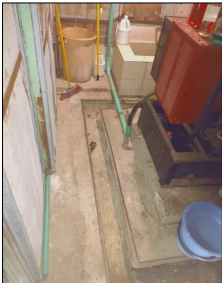
Cuarto Planta Eléctrica
