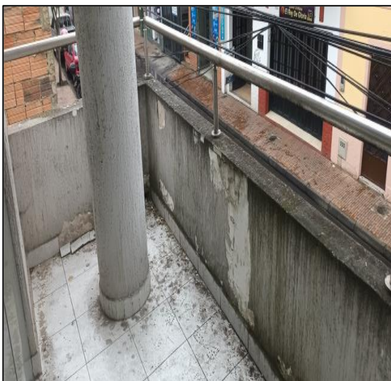
Pintura En Karraplas Caída Y Abandonada Por Efectos De La Intemperie
