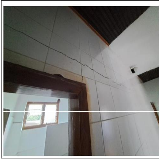
Fisuras En Enchape De Muros En Baño
