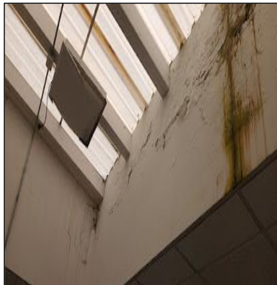
Humedad En Muros De Soporte Para Cerchas De Cubierta
