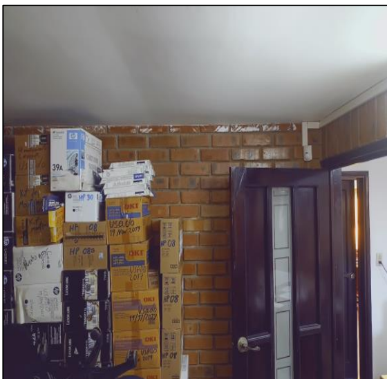
Cuarto De Rack, En Mampostería A La Vista, Cielo Raso En Drywall, Acumulación De Equipos De Cómputos Y Cajas
