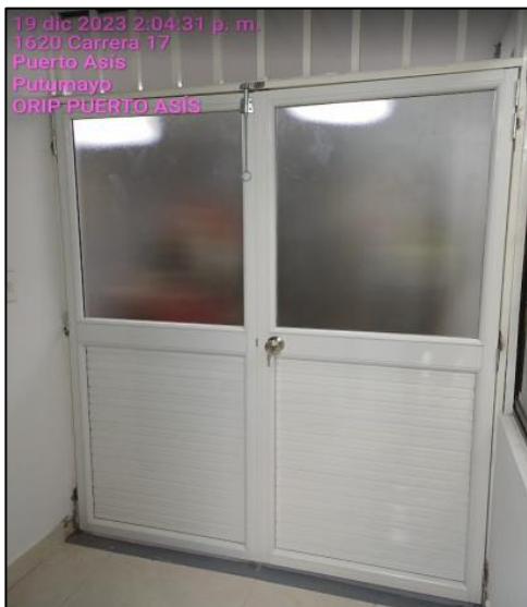
Puerta En Aluminio Acceso A Cuarto De Planta.
