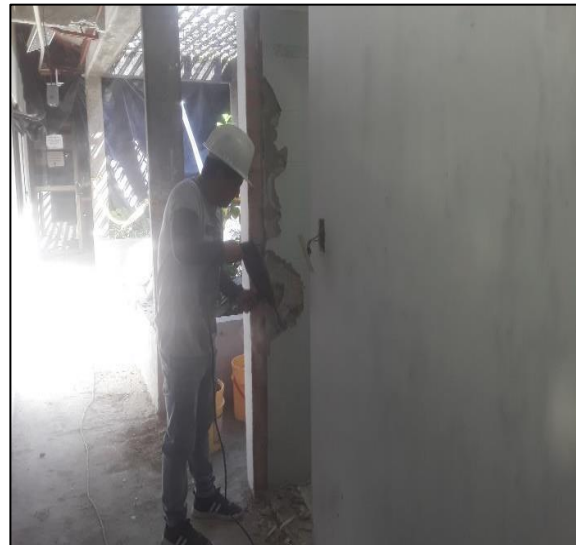
Pañete O Revoque En Baño Auxiliar
