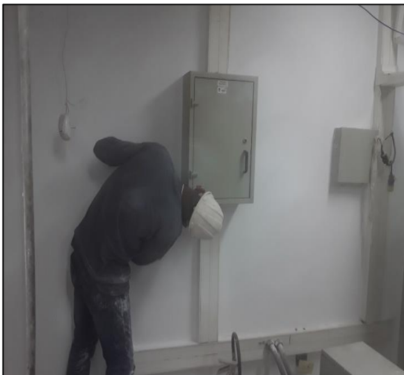
Pintura Segunda Mano En Área De Equipos
