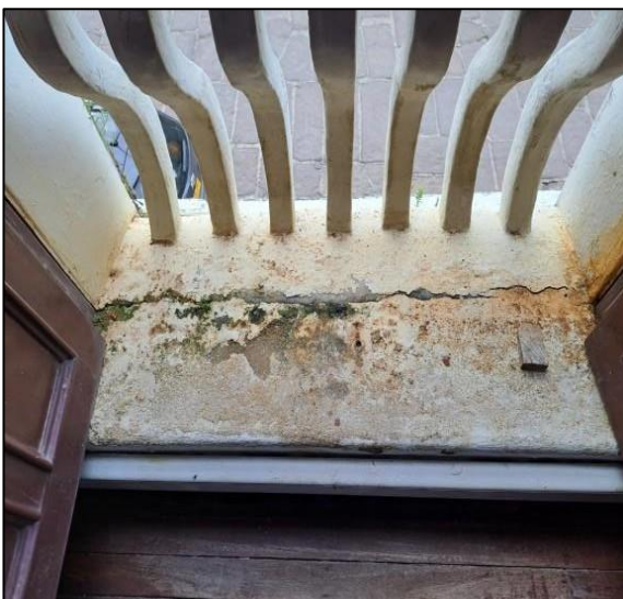
Humedades En Oficina Principal
