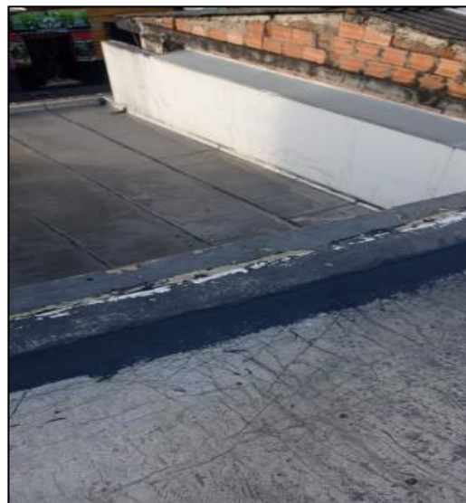
Deterioro De Manto Asfáltico A Causa De La Intemperie
