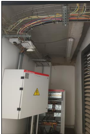
Gabinete Eléctrico – Red De Datos
