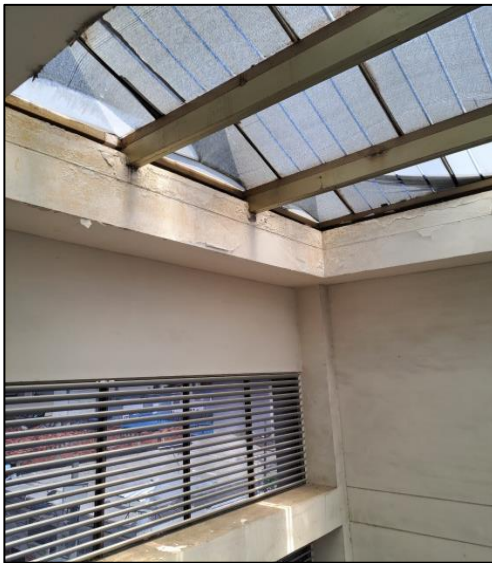
Presencia De Humedad Acceso Principal
