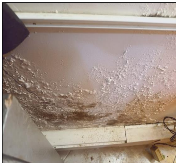
Humedad En Muros De Oficina De Notario Debido Al Calor Emanado Por Equipos De Aire Acondicionado En El Exterior
