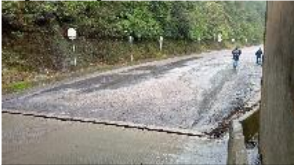
PR47+0270 Superficie de rodadura salida del túnel 2 en mal estado
