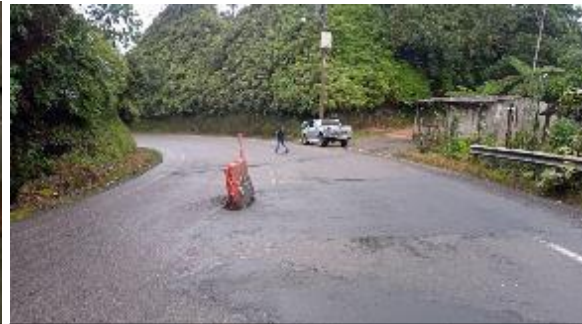
PR 55+770 Hundimiento de la superficie de rodadura.
