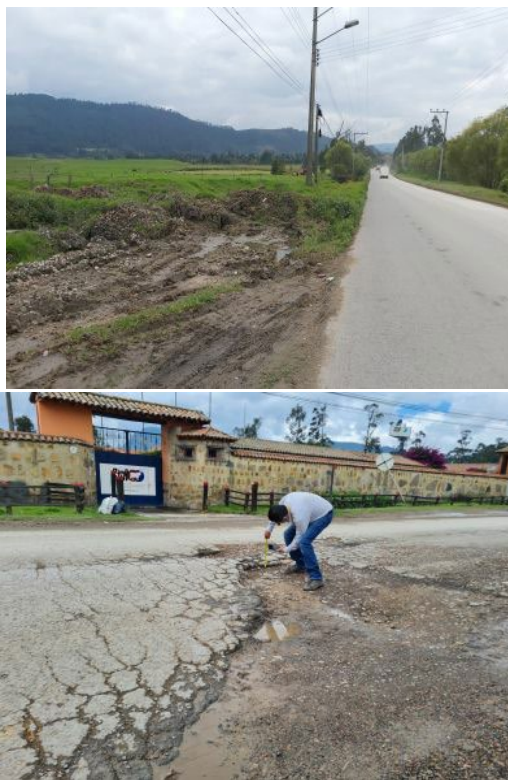
Fotografía 4 Tramo con carpeta asfáltica desgastado
