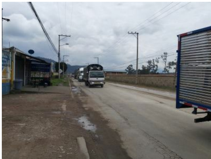
Fotografía 1 Piel de cocodrilo en el pavimento
