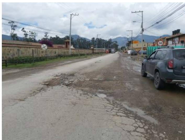
Fotografía 2 Perdida de estructura de pavimento
