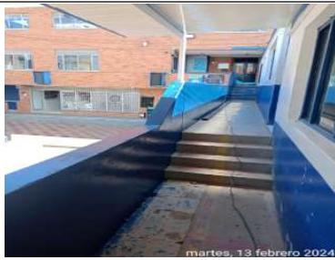
pintura en circulación
