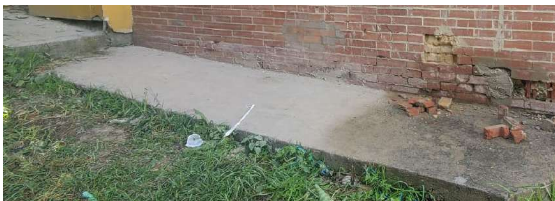
Imagen 3. Estado columnas, vigas y andén exterior. Fecha: 15-03-2024
