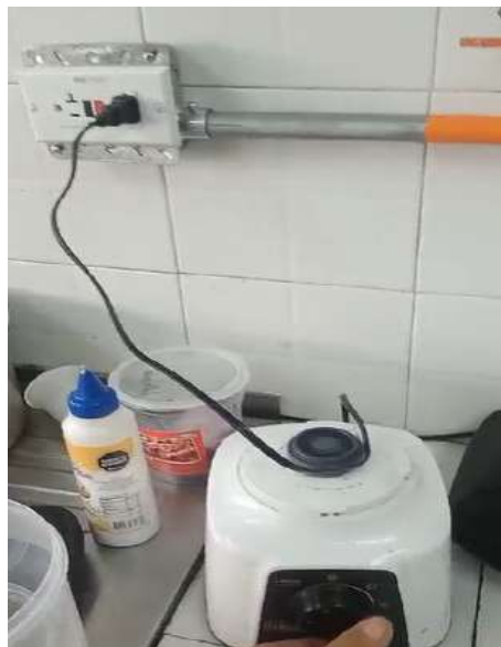
Ilustración 2 Prueba funcionamiento toma GFCI.
