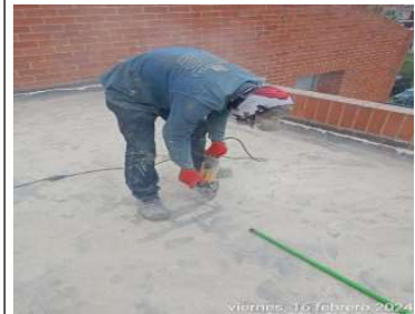
inducción de fisuras de placa 1er piso
