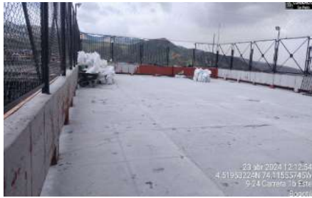
Sello de fisuras
