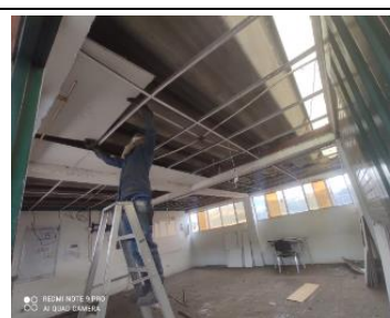
Desmorte de cielorraso en Aula 302
