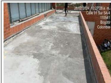
Inducción de fisuras de placa 1
