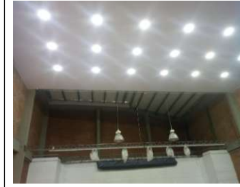
Instalaciones eléctricas y luminarias
