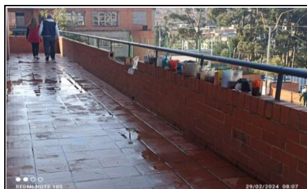
Estado inicial mamposteria y baranda
