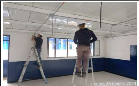
instalaciones de red electrica
