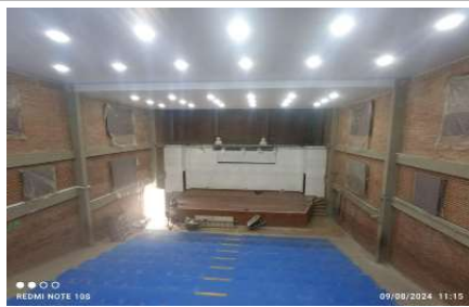
Instalaciones electricas y luminarias
