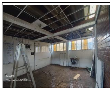
Desmorte de cielorraso Aula 302
