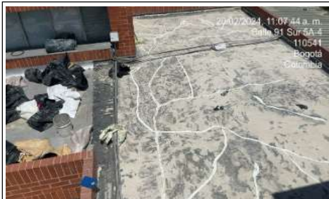
Inducción de fisuras de placa 1
