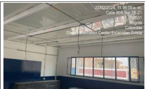
instalaciones de red electrica
