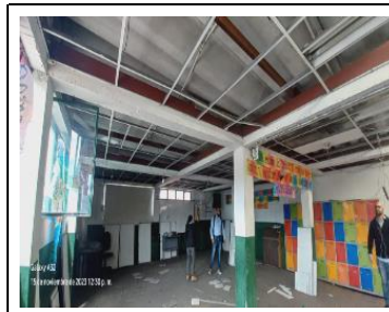
Desmorte de cielorraso en aula 301
