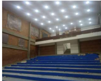
Instalaciones eléctricas y luminarias
