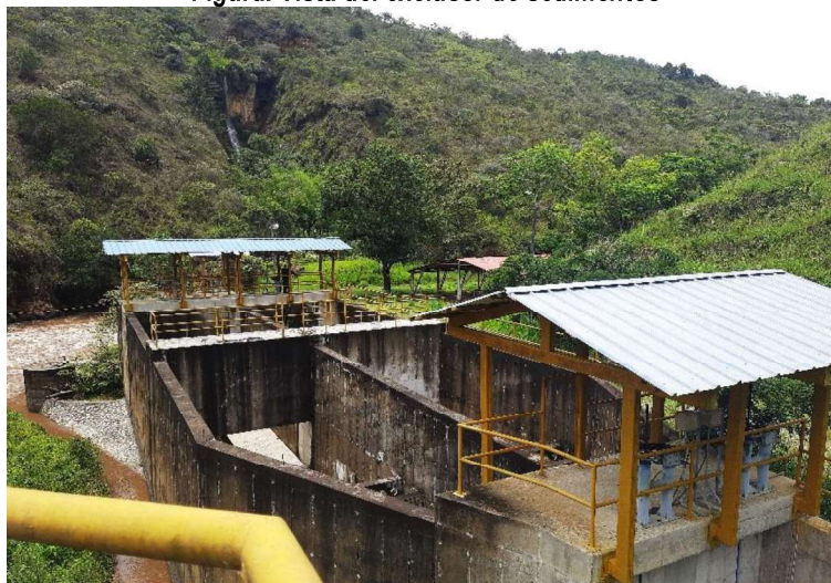
Figura. Vista del exclusor de sedimentos
