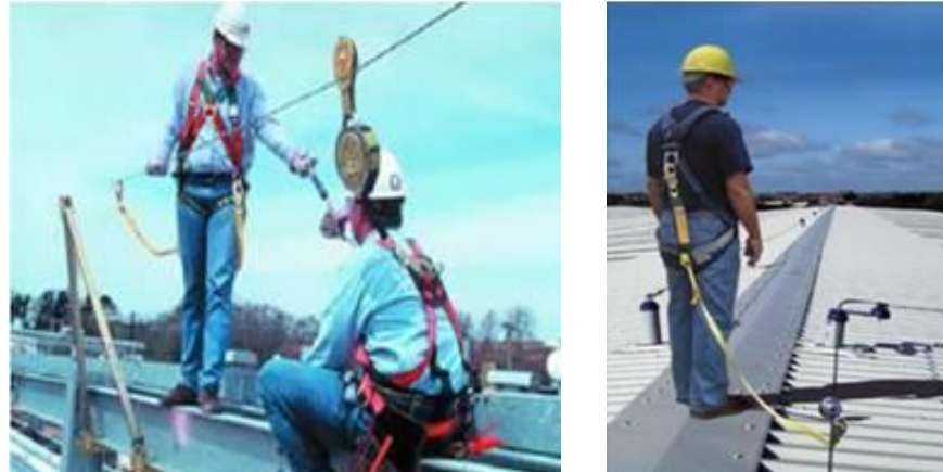
Figura 17. Líneas de vida para desplazamiento horizontal.
