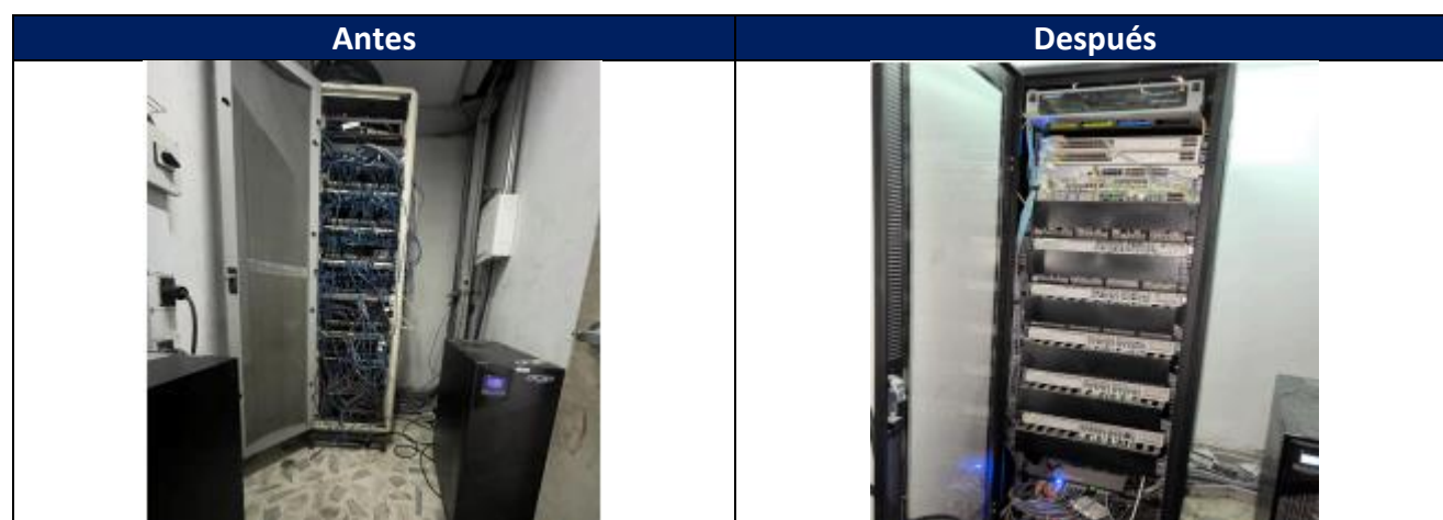
Ilustración 5 Estado actual equipos estación 1
