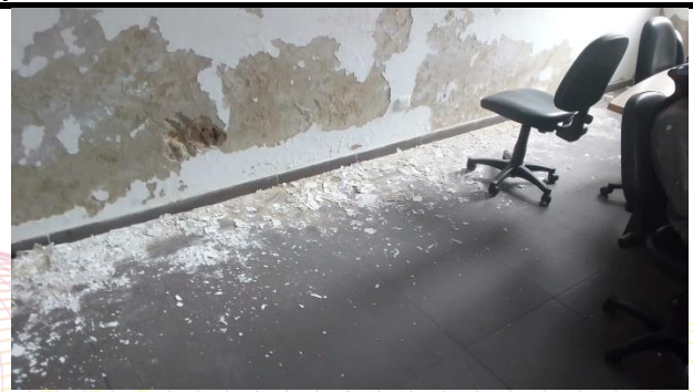
Foto 6. Estación de policía XIV Mártires. Resanes de humedad en casa táctica.
