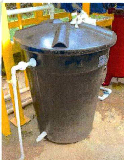
Tanque almacenamiento agua natural
