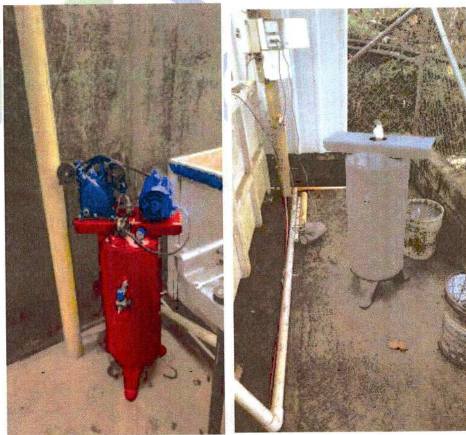
Pintura general del compresor de la PTARL
