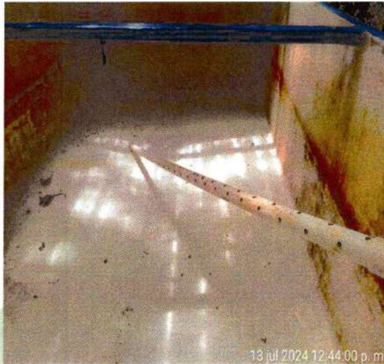
Limpieza unidad y flauta interior
