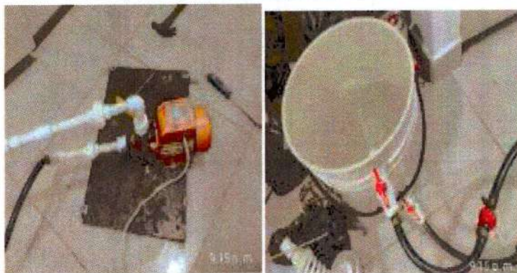
Ensallo de la bomba evans des pues del mantenimiento integral
