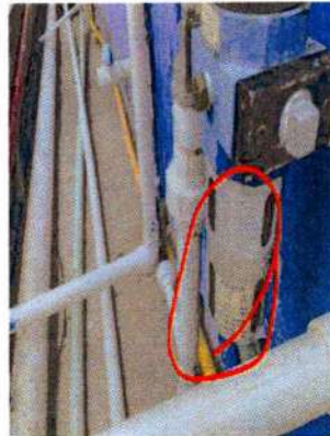
presencia de agua en trampa de grasas secundaria
