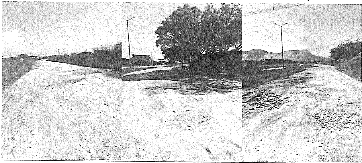
Figura 11: Registro fotográfico estado actual de la vía Avenida primera entre calle 50 y calle 60
