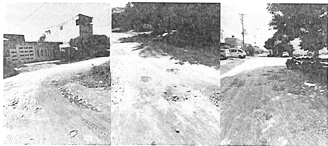
Figura 17: Registro fotográfico estado actual de las vías internas del barrio villa lucia
