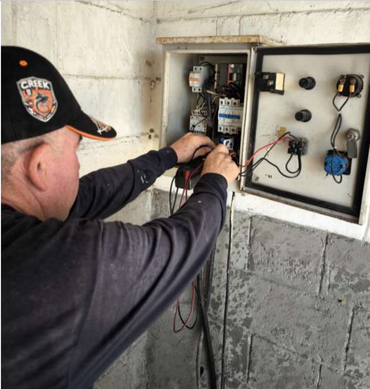
Fotografía verificación de amperaje y tensión del pozo profundo complejo de combustible
