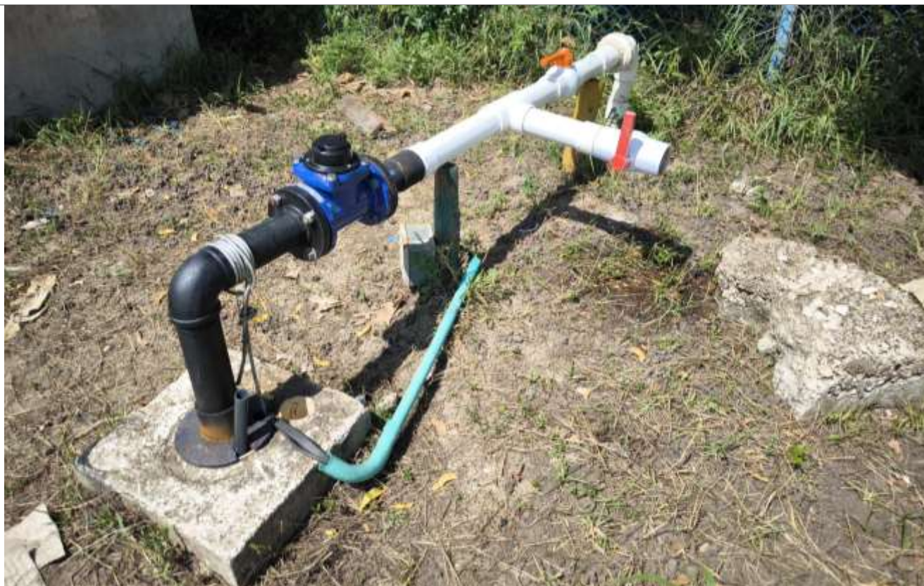
Fotografía instalación macro medidor nuevo pozo Dragoncitos
