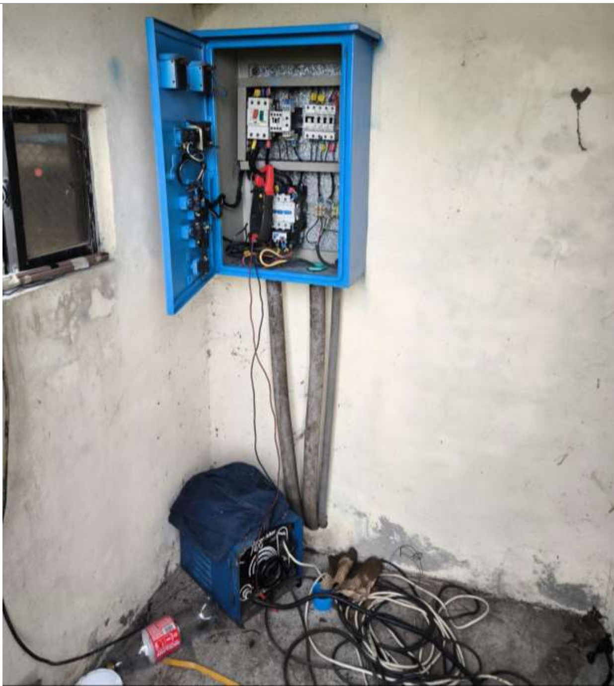
Fotografía tablero de control Dragoncitos
