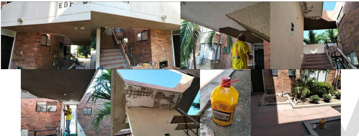
Imagen No. 9 – Pañete de fachada bajo placa de zonas comunes del edificio.
